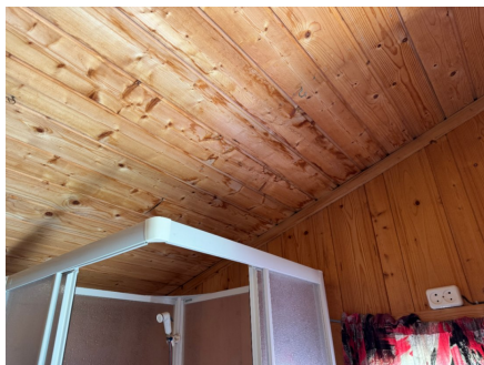
Fuktmerker i innvendig himling på dusjrom
