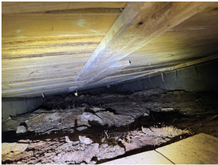
Fuktmerker i treverk mot krypkjeller
