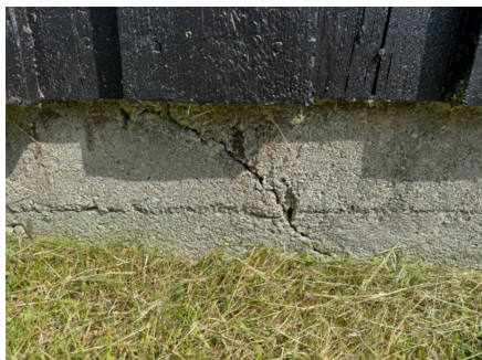
Setningssprekk i grunnmur
