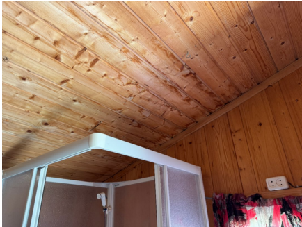
Fuktmerker i innvendig himling
