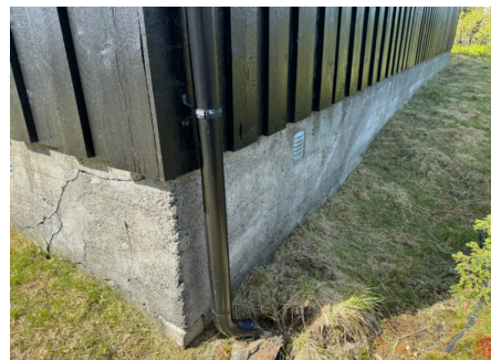
Setningssprekk i grunnmur
