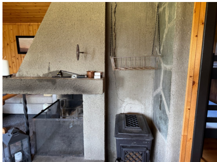
Sprekker i overflater
