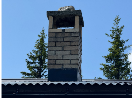
Noe forvitring av fuger på pipe over tak
