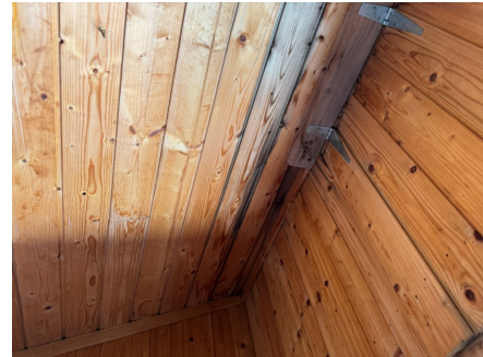
Fuktmerker i innvendig himling
