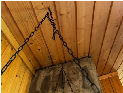
Fuktmerker i himling rundt pipe
