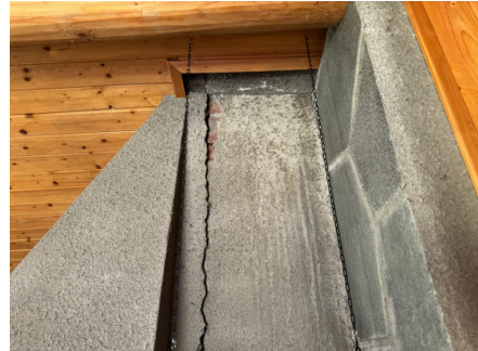
Sprekker i overflater
