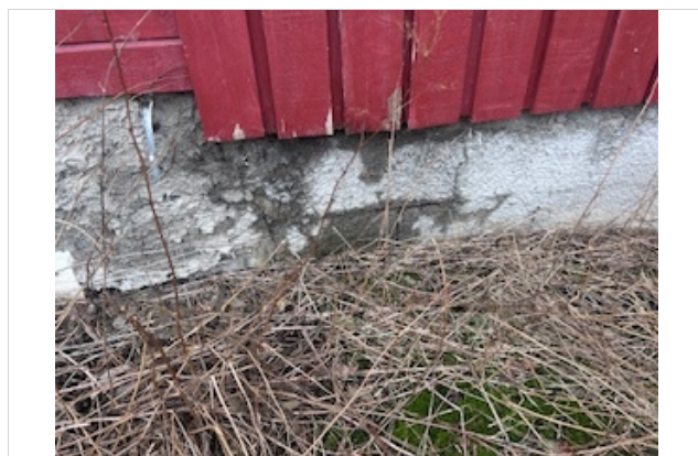
Fukt som kommer ned mellom hytte og verksted baksiden
