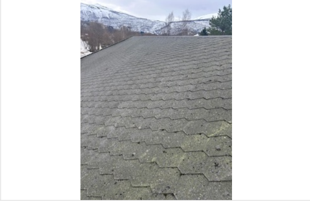
Noe mosegrodd shingel på tilbygg.
