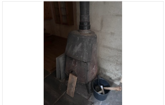
Vedovn tilkoblet stålør elementpipe over tak.
