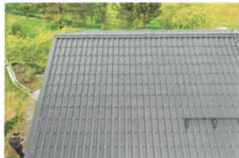
Mangler snøfangere på deler av taket.
