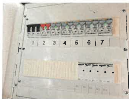
Fordelingsskap i garasjen/boden.
