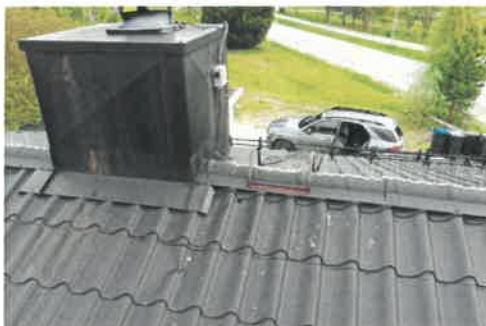
Mønehengt takstige, noe rust på pipebeslag.
