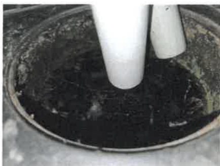
Sluk under dusjkabinett
