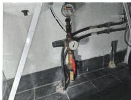
Stoppekran med reduksjonsventil og vannmåler.
