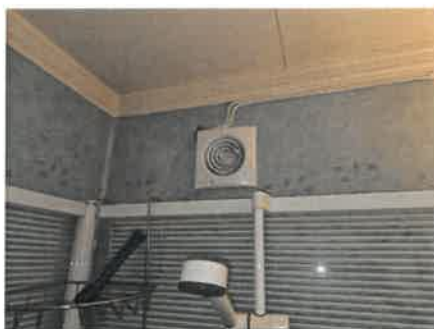
Ventilasjon via el-veggvifte.
