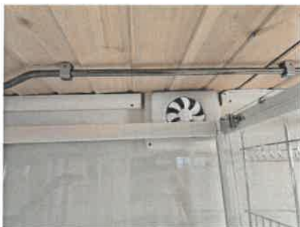
Ventilasjon via el-veggvifte.
