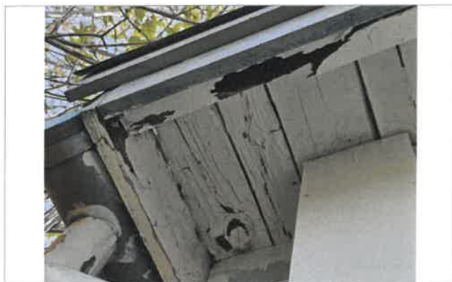
Råteskader i takutstikk på garasjen.
