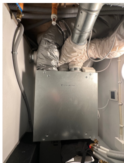
Ventilasjonsaggregat er plassert i teknisk rom.
