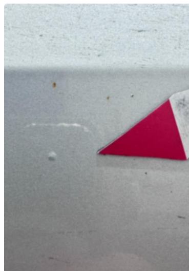
1.2 Steinsprut med korrosjon venstre og høyre skyvedør nedre del og høyre vindusramme fordør.
