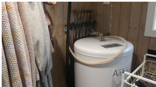
200 liter v.v.bereder i bad/vaskerom
