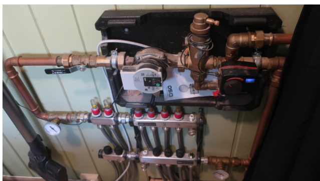
Rørapplegg i teknisk rom for gulvvarme.
