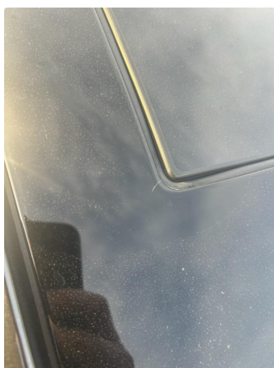
1.4 Noen små sprekker på glasstak.
