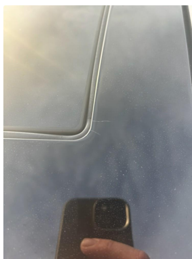
1.4 Noen små sprekker på glasstak.
