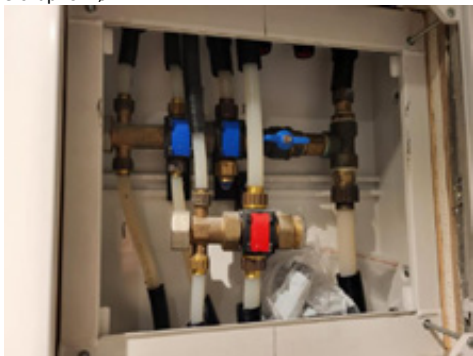
Fordelerskap for rør
