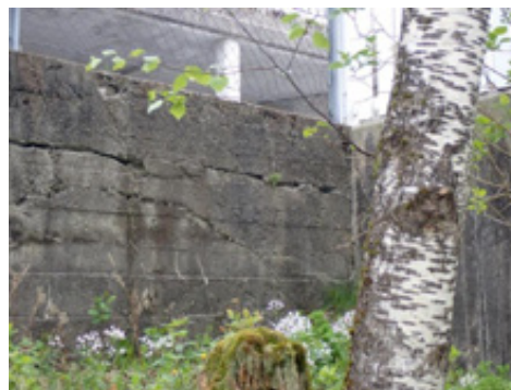
Sprekker i veimur.
