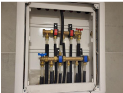
Fordelerskap for rør
