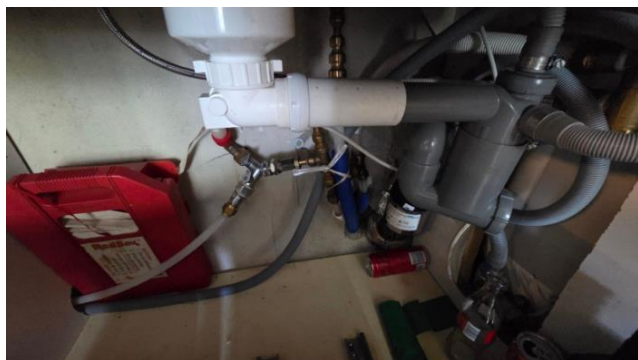
Brannslange i benkeskap på kjøkken.
