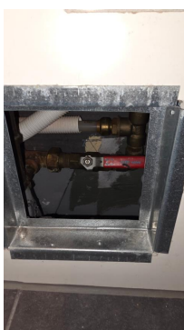
Stoppekran i luke i vegg på badetrom.
