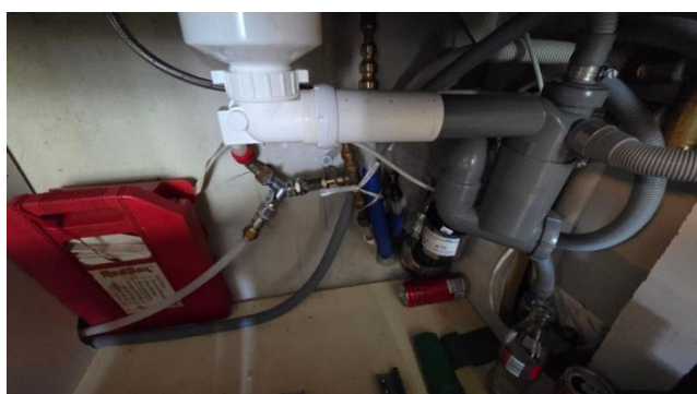
Plast avløpsrør i leiligheten.
