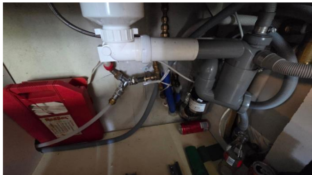
Vannrør i plast.
