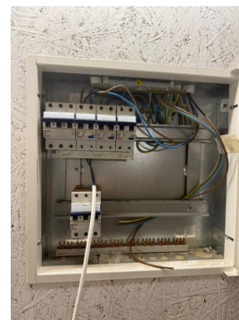
Ufagmessig arbeid i sikringsskap i garasjen
