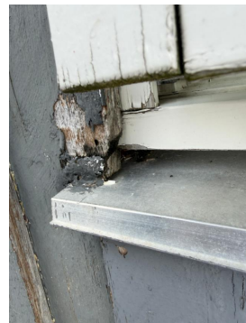
Trekledningsbord lagt helt ned på det nederste vannbrettet
