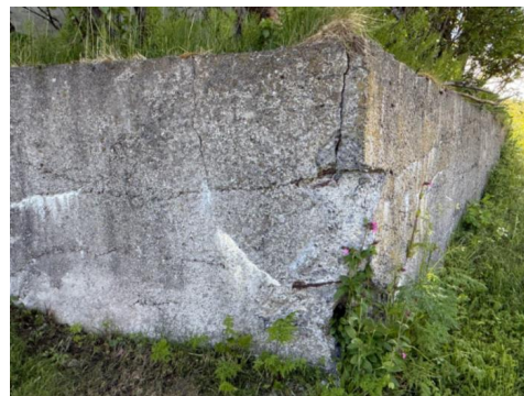
Synlige sprekker og skader, samt eksponerte armeringsjern
