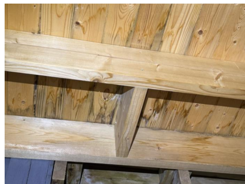
Fuktskjolder synlige fra undersiden
