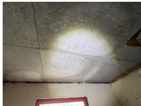
Eternittplater i garasjen under stuen
