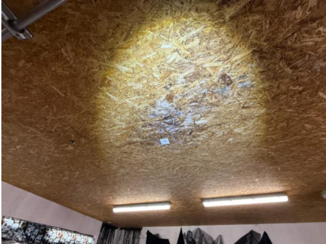
Fuktskjolder synlige fra undersiden
