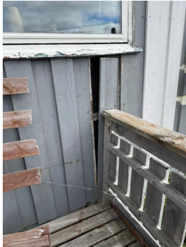
Skade på kledning pga. skjev terrasse.
