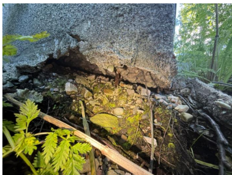
Utsig av masser og synlig eksponert armeringsjern.
