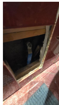
Kobberør med plastkapsel. Stoppekran på toalettrom. Ukjent alder.
