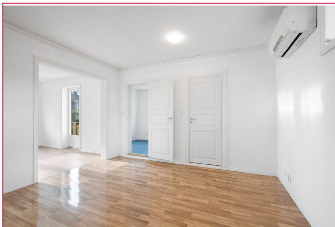
Stue med varmepumpe
