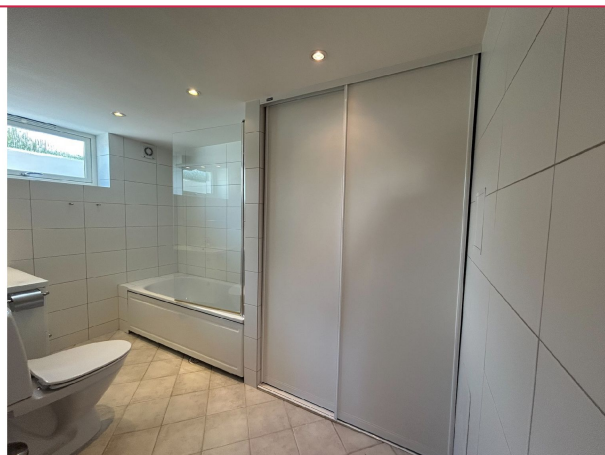
Bad i kjeller
