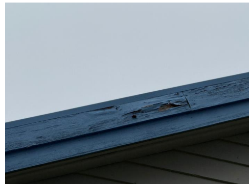
Indikasjon på råteskader i endebord på hovedtaket
