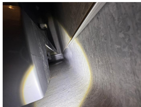
Mangler fuger i nederkant av våtromsplater i våtsoner
