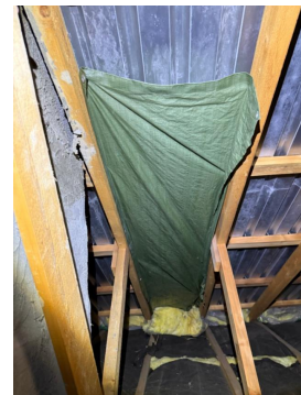
Provisorisk utbedring med presenning.
