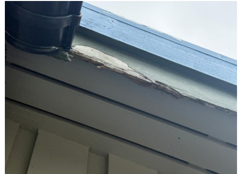
Råteskader over hovedytterdør
