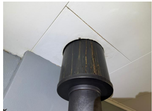
Svellinger i himlingsplate og rennemerker fra pipen
