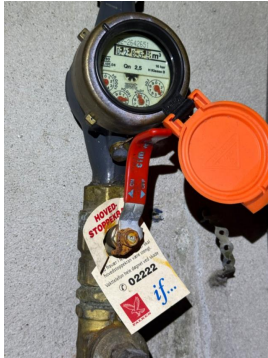
Hovedstoppekran og vannmåler
