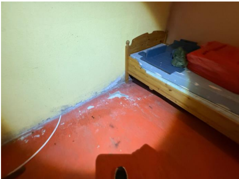
Avflassinger på malt betonggulv i kjelleren
