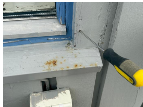
Råteskade i trevirke som er lagt helt ned på beslaget på det nederste vannbrettet
