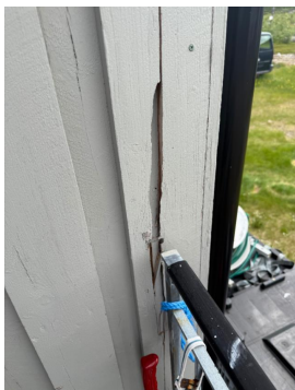
Skade i kledningsbord ved trappa
