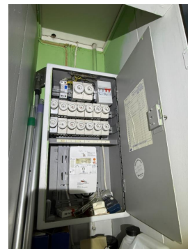
Sikringsskap i vindfang tilliggende badet
