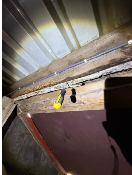
Råteskader i takkonstruksjonen
