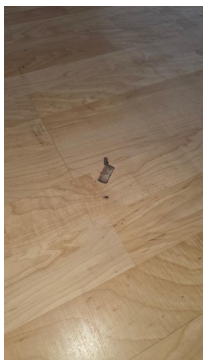
Skader på overflater laminatgulv.
