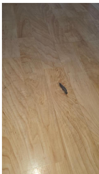
Skader på overflater laminatgulv.
