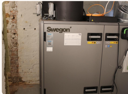
Swegon-aggregat i teknisk rom
