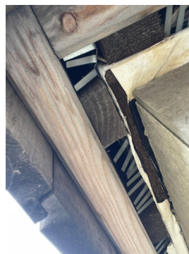
Ved stikkprøver ble det registrert avvik på musebånd.
