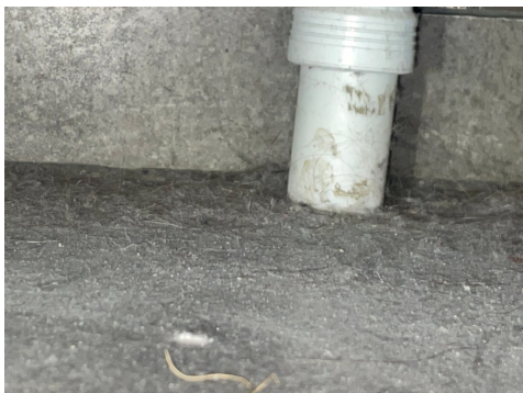
Manglende tettesjikt på rørgjennomføring.
