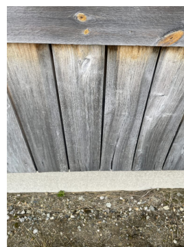
Sprekker utover normal slitasje/aldring.
