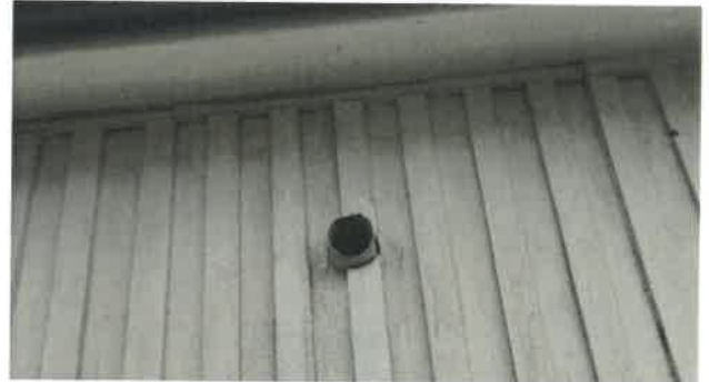
Kloakklufting opplyst ført på yttervegg. Manglende ventildeksel på kloakklufting, noe ufagmessig utført.
