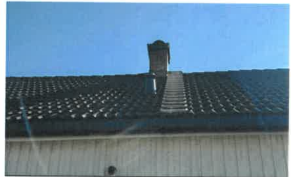
Opplyst luftehatt fra 2006, er ikke tilkoblet for utlufting av kloakk pr i dag.
