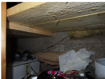
Påvist sprekkdannelser i muren pga jordtrykk.
