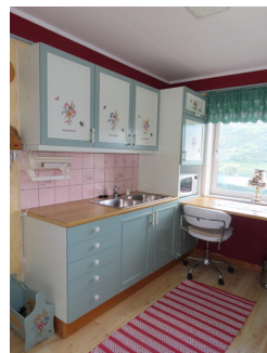
Kjøkken fremstår med naturlige renoveringsbehov jfr. alder.
