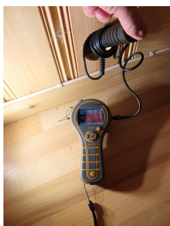
Påvist forhøyede fuktverdier ved fuktsøk i vegg.
