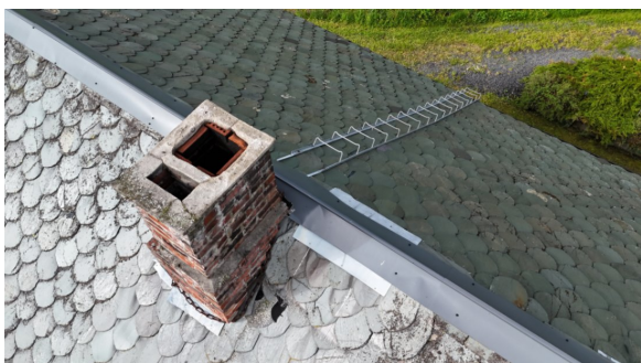
merk påvist sprekkdannelse i støpt pipekrans på topp pipe. Ett røkløp samt ett luftløp.
