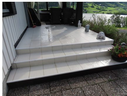
Åpen del ut for stue med påvist løse fliser på hele arealet pga fukttilsig og frostsprengninger i under fliser.
