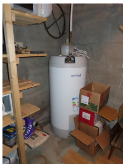
Vanninntak, bereder samt trykksatte rør.
