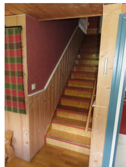
Trapp fra 1 til 2.etg. manglende håndløper på en side.
