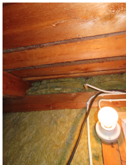
Isolert skråtak etablert uten luftespalte mellom taktro og isolasjon.
