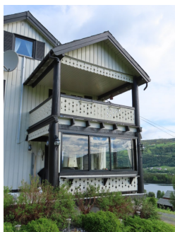
Høyde på rekkverk er målt til 82 cm i 2.etg.
