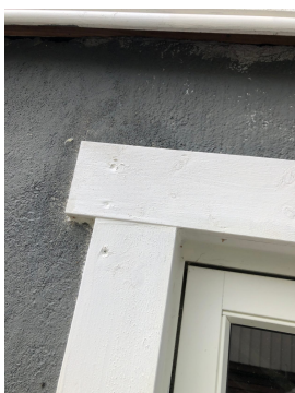
Bildet viser kjellervindu med mangelfulle beslagsløsninger.
