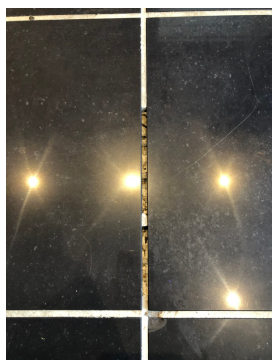
Bildet viser løs fugemasse på vaskerom. Bom i flis også registrert.
