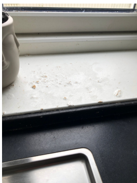
Bildet viser eksempel på fuktskader på innvendige foringer, dette er på kjøkken.
