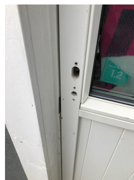
Bildet viser dør men manglende håndtak og lås.
