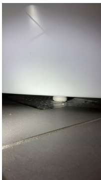
Sluk under badekar (ikke tilgjengelig for inspeksjon).
