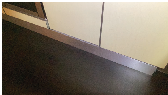
Sokkel under skap bør utbedres.
