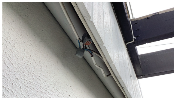
Ufagmessig utførelse, løse ledninger og mangler koblingsboks.
