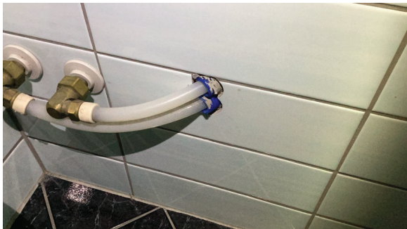
Ufagmessig utførelse ved gjennomføringer.
