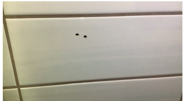
Hull i vegger etter tidligere installasjoner.
