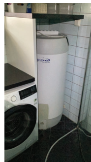
Varmtvannsbereder fra 2006 på bad i 2. etasje.
