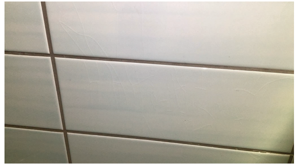
Riss i fliser flere steder.
