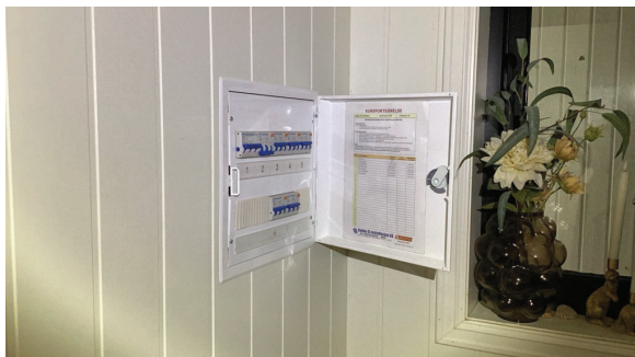
Sikringsskap på soverom.
