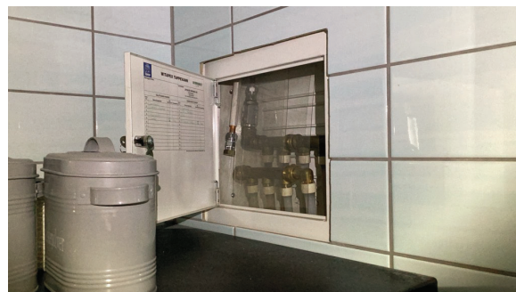
Fordelerskap på bad i 2. etasje.
