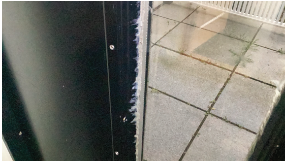
Ufagmessig utførelse på deler av arbeid.
