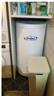
Varmtvannsbereder på bad/vaskerom.
