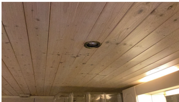
Spotter på bad i 1. etasje virker ikke.
