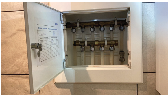
Fordelersskap på bad.
