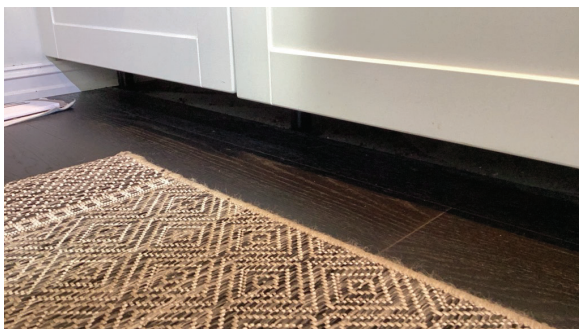
Mangler sokkel på kjøkken.
