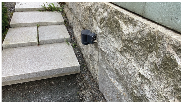
Løse utvendige lamper.
