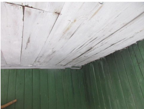
Skade i himling i verandaen.
