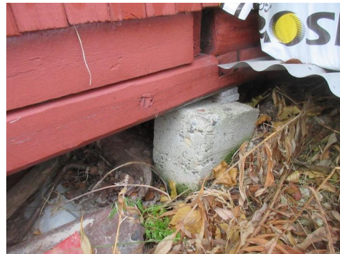
Betongpeler, med trekiler. Fundamentet er ute av lodd.
