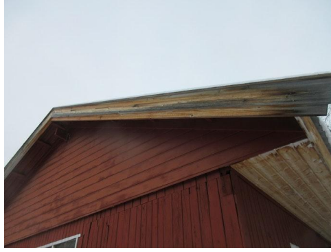
Malingslitt /skadet vindskibord
