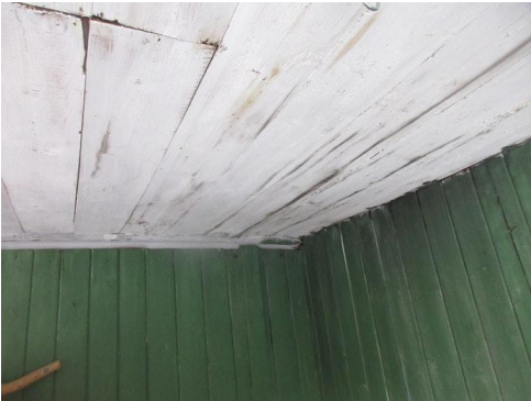
Spor etter fukt i himling i VF/veranda
