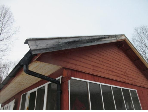
Malingslitt /skadet vindskibord
