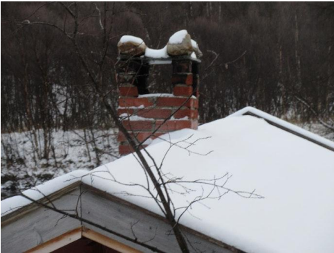
Pipe over tak.
