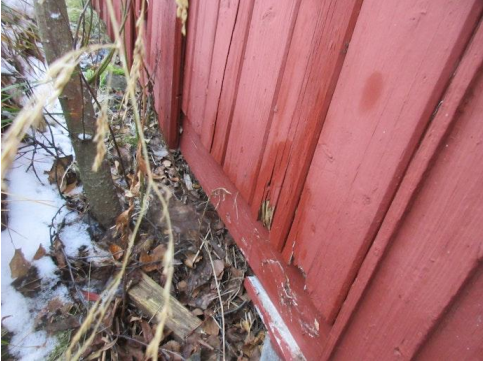
Råteskade på vegg nederst på vegg
