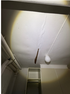
Indikasjoner på fuktskader i himling under badet
