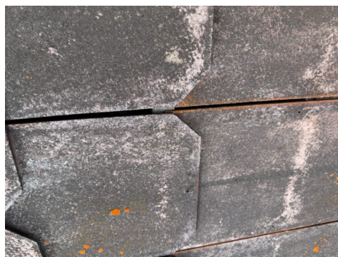
Sprekker mellom takplater
