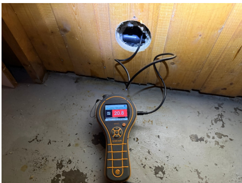
Fuktmåling i bunnsvill i vegg mot terreng.
