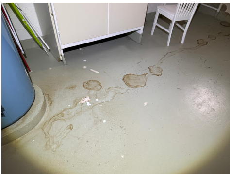
Fuktskjolder på gulvet under i rom under badet
