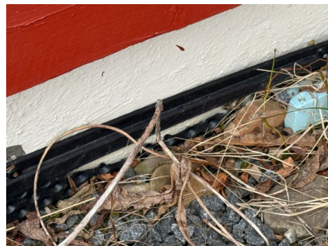
Åpning mellom grunnmursplast og kantlist
