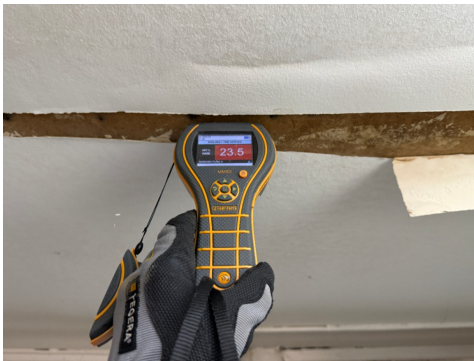
Høyt fuktinnhold i himlingen under badet
