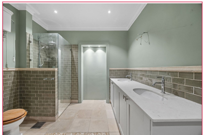
Fint nyoppussett bad med badekar og dusj. Speil og belysning blir montert.
