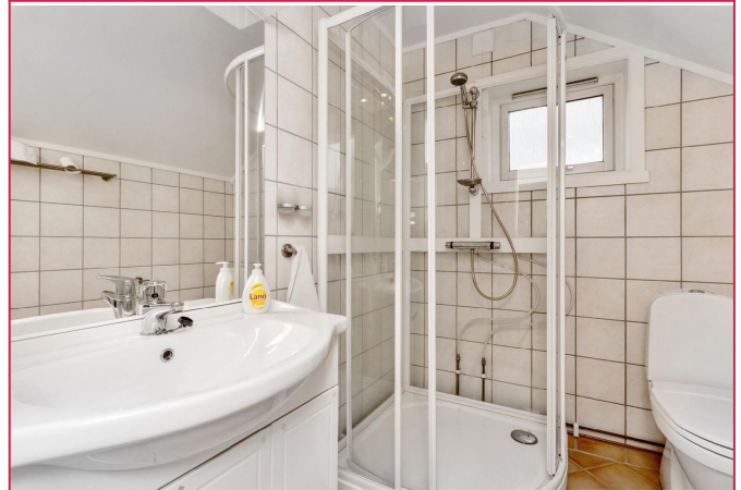
Bad i 2.etg. Opplegg for vaskemaskin på vaskerom i kjeller.
