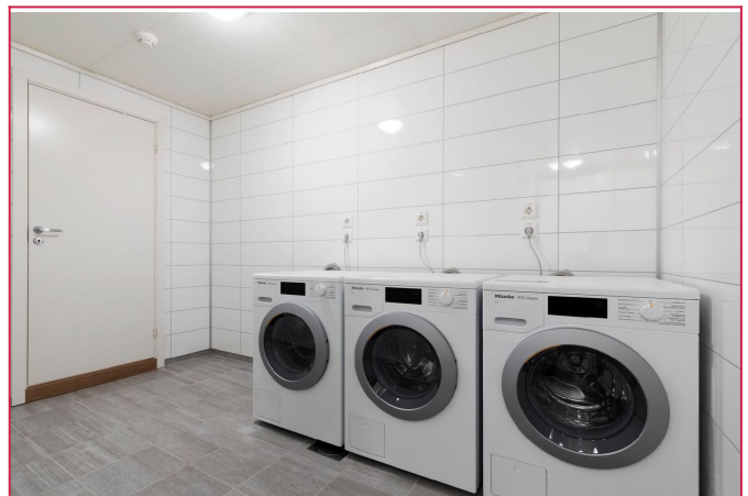
Vaskerom i kjeller
