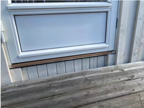
Døren mangler beslag i nedkant.
