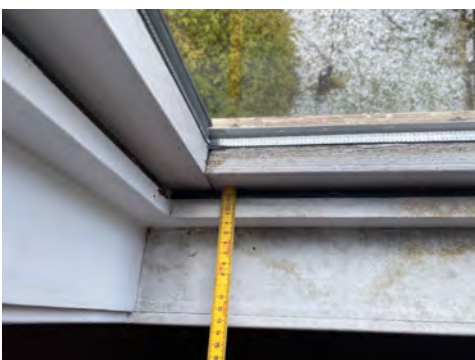
Vindu i loftsetasjen kan ikke lukkes tilstrekkelig.
