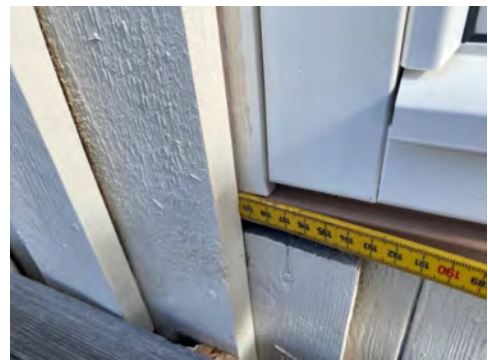
Glippe mellom dekkbord og karm.
