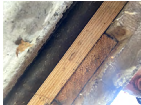
Mangelfull lufting bak kledningen.
