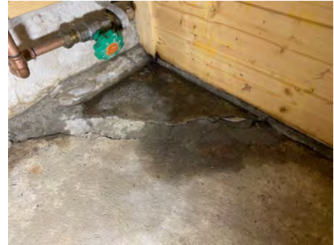
Vanninnsig i kjeller.
