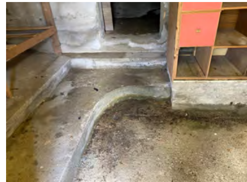
Fukt/saltutslag mot betongvegger/gulv.
