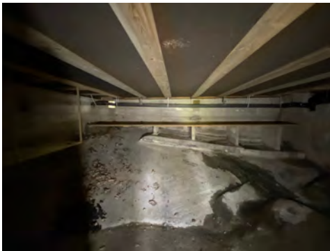
Det er ikke tilfredsstillende ventilering av krypkjeller, flere ventilert bøl åpnes/etableres for å kunne øke ventileringen.
