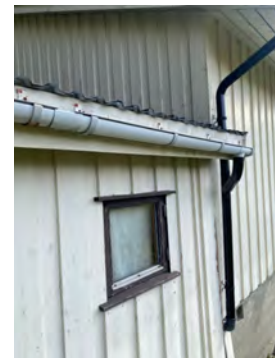
Manglende spielblikk mellom takrenne/takplater. Innfestning i kroker har rust.
