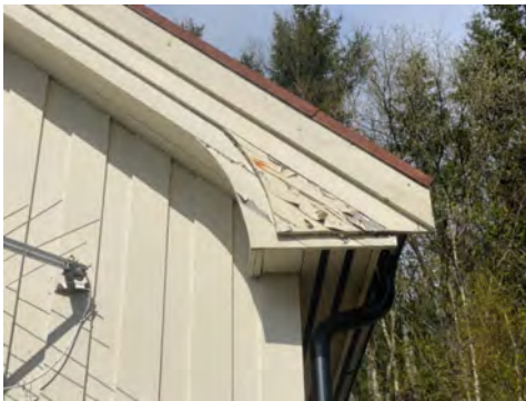
Værslitt/malingsavflassing mot vindskie.
