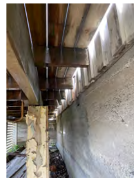
Ingen synlig innfestning mot vegg
