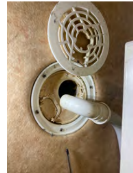
Plastsluk under innredning med avløp fra vask.
