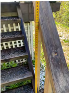
Rekkverkshøyde, utvendig trapp.
