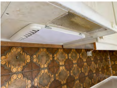
Funksjonstest av ventilator.
