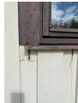
Utvendige omrammingsbord på vinduer er stedvis satt helt ned på beslag, skadeutsatt løsning med fuktopptrekk og påfølgende råteskader.
