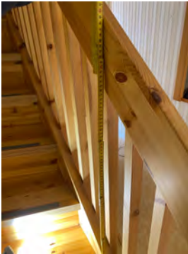
Høyde rekkverk i trapp til loftsetasjen.
