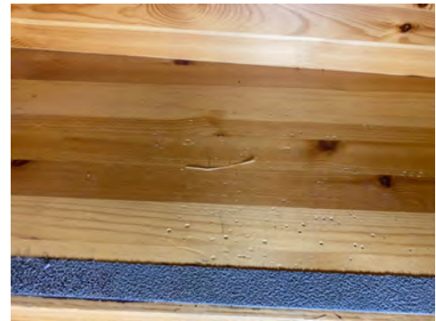
Enkelte hakk i overflate trinn
