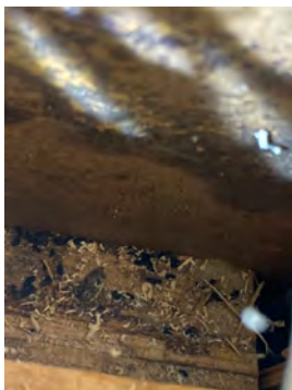
Ekskrementer fra mus i innvendig vegg mot badet i hovedetasjen.
