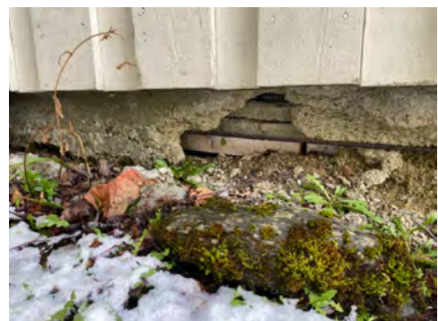
Skader i mur mot bod.
