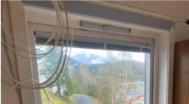
Naturlig ventilering via ventiler i vinduer.
