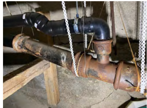
Motfall på avløpsrør i plast
