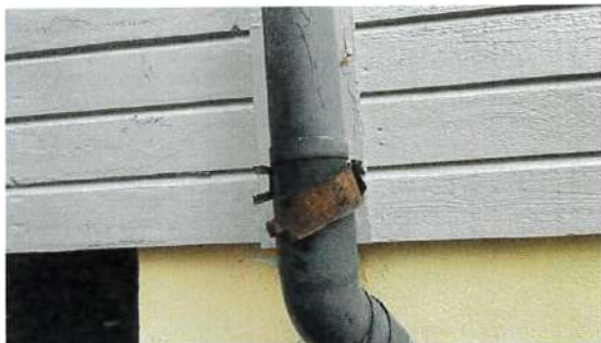
Rustskade innfesting taknedløp
