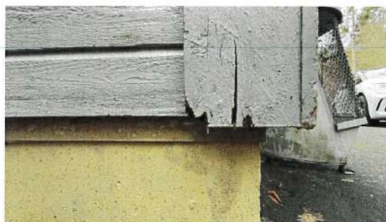
Råteskade i hjørnebord
