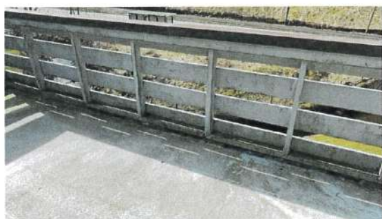
For store mellomrom mellom spiler
