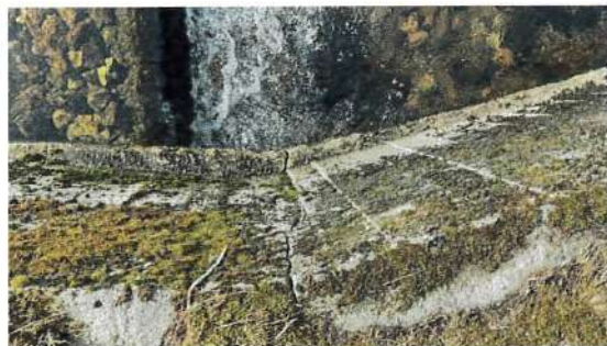
Sprekker i forstøtningsmur v bekk
