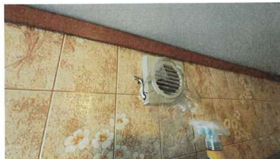
Avtrekksvifte fungerer ikke
