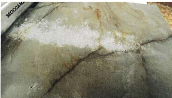
Slitasje i benkeplate
