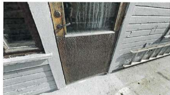
Punktert glass og utvendig slitt balkongdør
