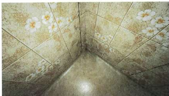
Belegg og tapet løsnet
