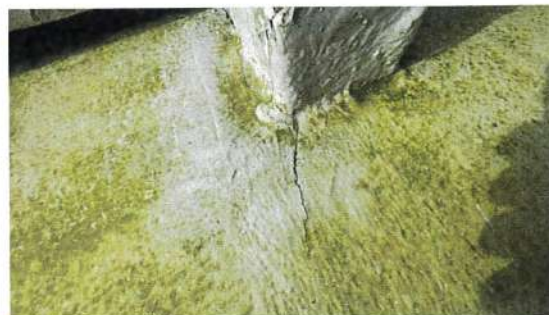
Sprekk i glassfiber 1. etg
