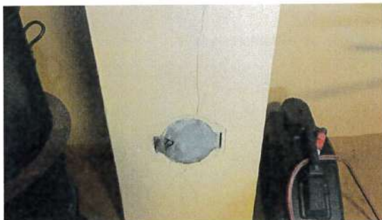
Sprekk i puss rundt sotluke
