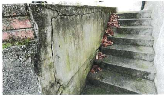
Sprekker i forstøtningsmur
