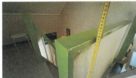
Lav høyde rekkverk trapp
