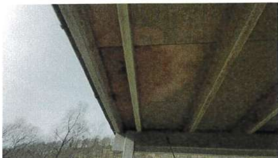
Fuktmerker fra underside
