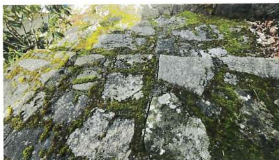
Noen sprekkdannelse i overflate
