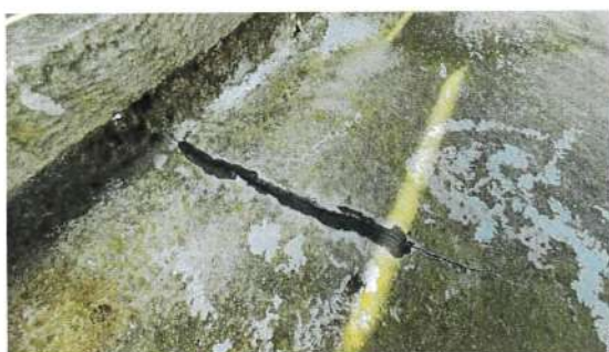
Sprekk i glassfiber 2. etg
