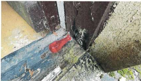
Råte i karm i kjellerdør
