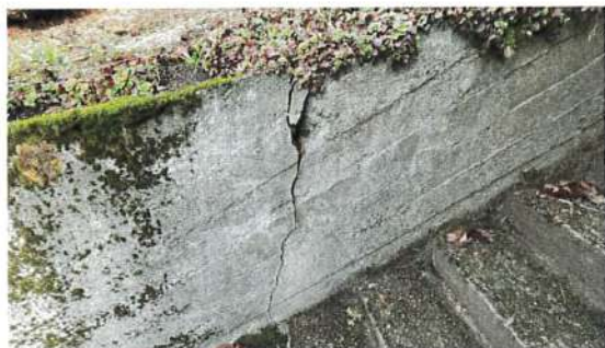
Sprekker i forstøtningsmur
