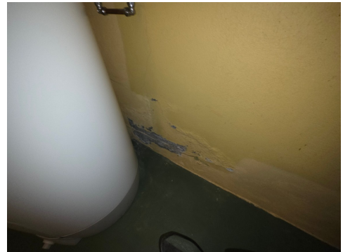
Fuktuslag på mur innvendig.
