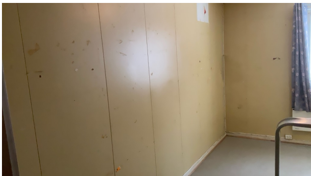
Veggplater på ett soverom med skader.
