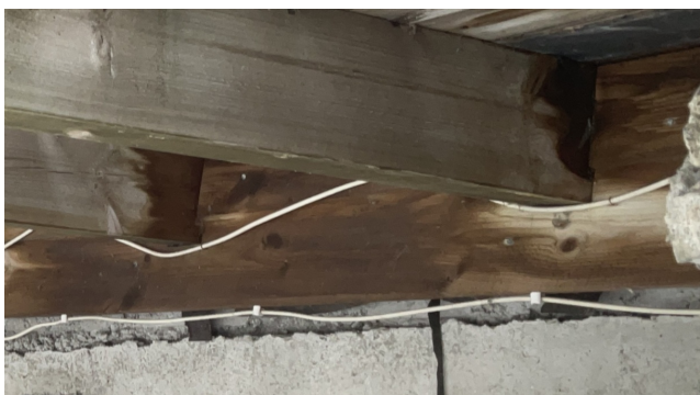
Råteskader i bjelkelag under balkong.
