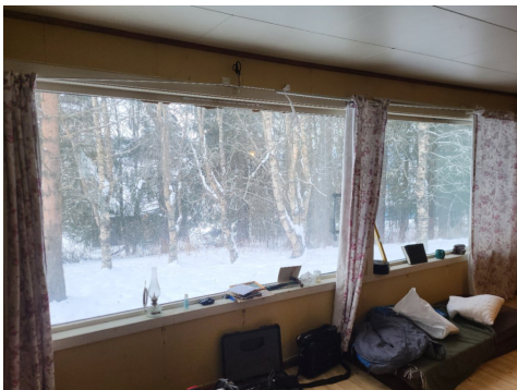
Stuevinduer er punktert.
