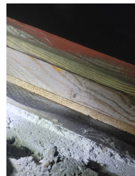
Ingen lufting under liggende kledning.
