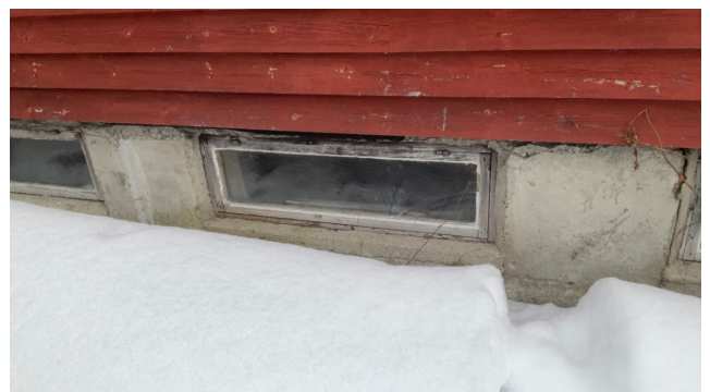
Råte på kjellervindu.
