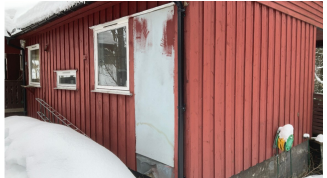
Dør inn til vaskerom er tettet med ei plate.
