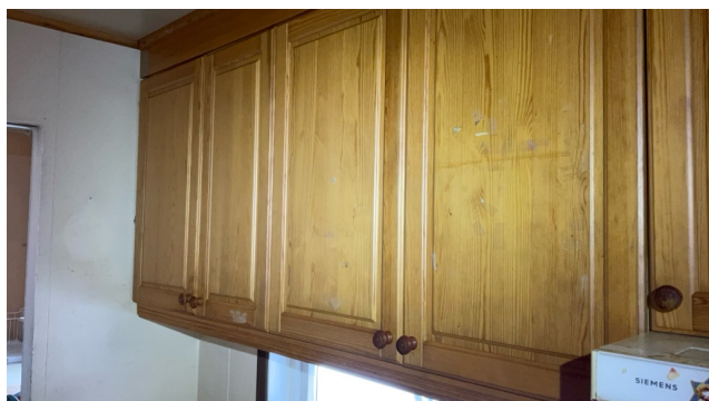
Slitasje på skap.
