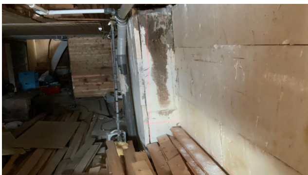
Laserstråle viser skjevhet i kjellervegg.
