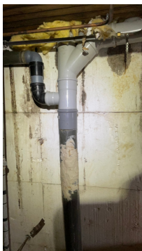
Avløpsrør er tettet med ukjent produkt
