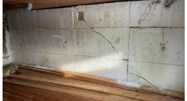
Isopor på vegg er knekt grunnet innsig av grunnmur.
