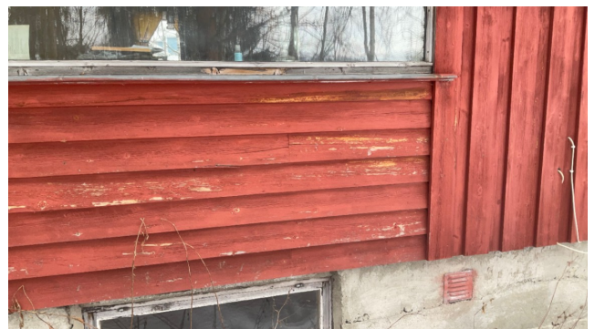
Sprekker i kledning under stuevinduer.
