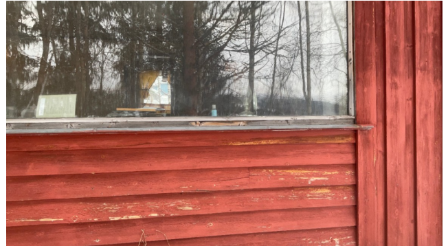
Utvendig råteskade på stuevinduer.
