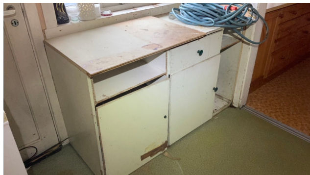
Ødelagte skap på vaskerom.
