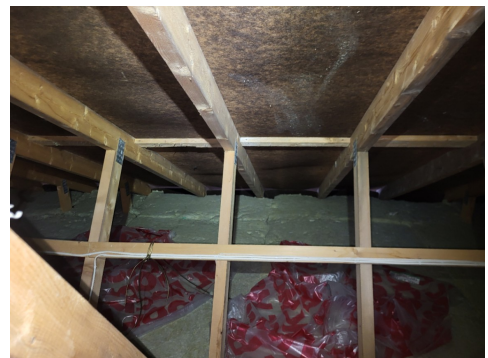
Fuktskjolder på undertak.
