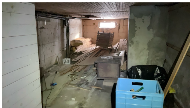
Materiallager på gulv, gulv kan ikke inspiseres.
