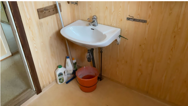
Lekkasje i avløpsrør under vask.
