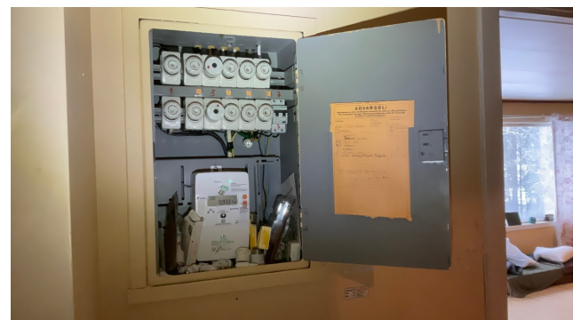
Sikringsskap med skrusikringer.
