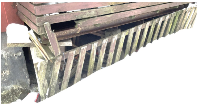
Betongpilarer under balkong har store skjevheter.
