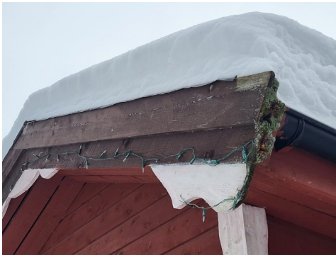
Råte på vindskibord
