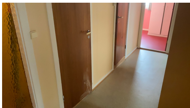
Skader og hull i innvendige dører
