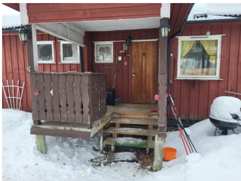
Skjevheter i telefonstolper under inngangsparti.
