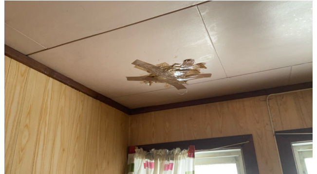
Ventilasjons gjennomføring er teipet igjen.
