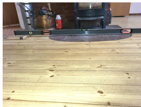
Skjevhet på gulv ved ovn i stue.
