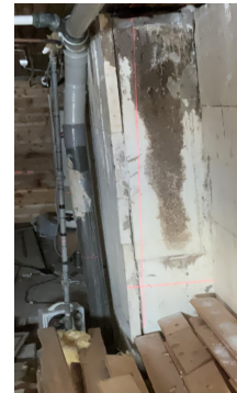
Laserstrek viser store skjevheter i grunnmur.
