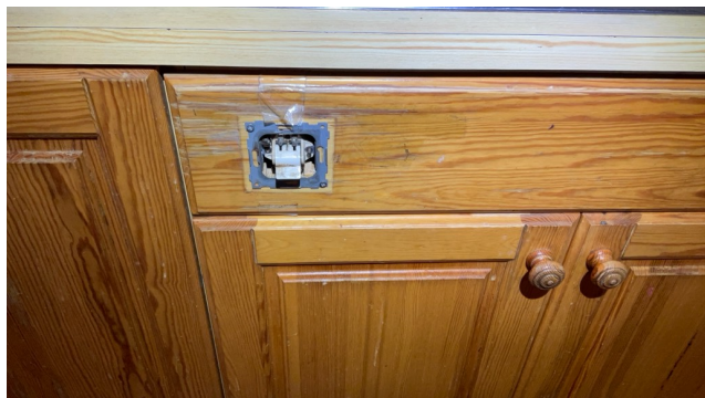
Slitasje på innredning.
