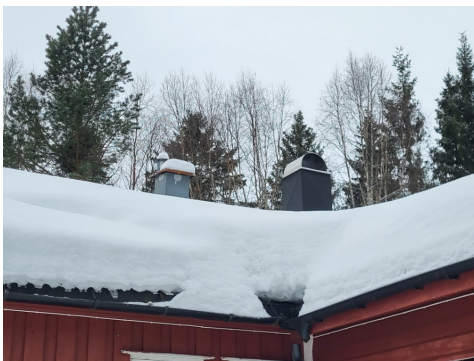
Rust på luftehatt
