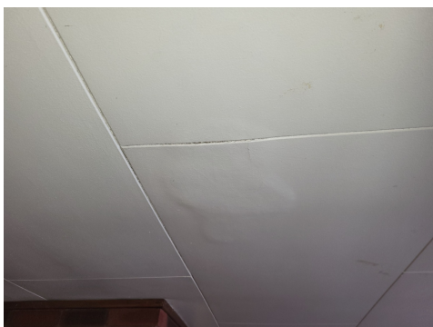
Vannskade i himlingsplater.
