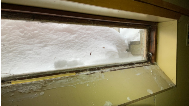
Kondensskade i karm.
