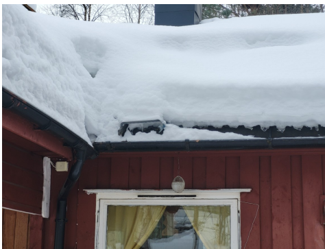
Takrenner av plast og metall, rust påvist på metallrenner.
