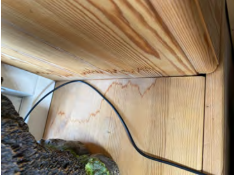
Tegn til fukt mot foring.
