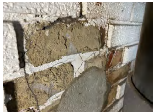
Riss i skorstein bak vedovn.
