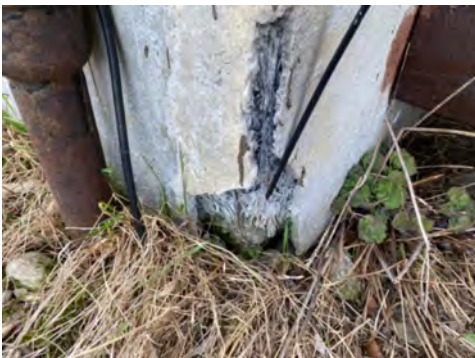
Skader i mur mot sørvest.
