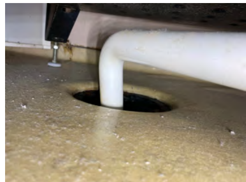
Rør i taket for ventilering.
