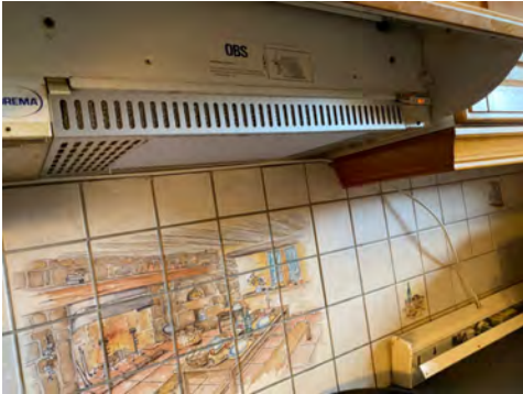
Funksjonstest av ventilator.
