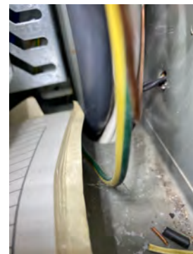
Manglende tetting rundt kabelgjennomføringer i el-skap.
