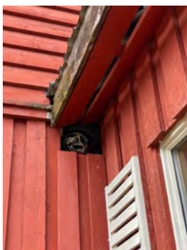
Avtrekkskanal mot utvendig vegg
