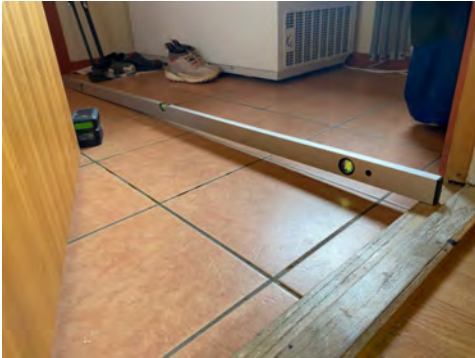
Skjevheter i gang/entre'.
