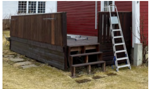
Det er registrert skjevheter i rekkverk.
