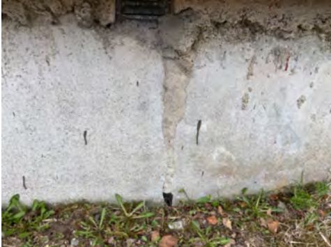
Sprekk i mur mot vest
