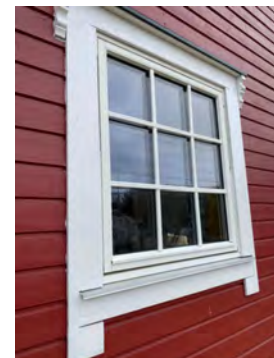
Store deler av vinduer er byttet i 2016/2017 ifg eier.
