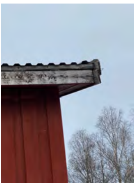
Stedvis manglende innfestning i takplater og beslag.
