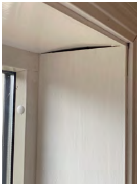
Stedvis glippe i sammenføring vindusforinger.
