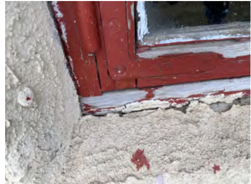
Mangelfull utvendig tetting.
