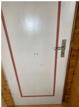
Stedvis merker i overflater på enkelte dører.
