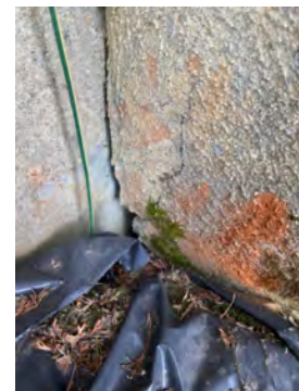
Utvendig sprekk i hjørnet på mur.
