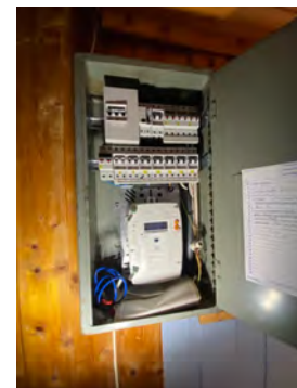
Sikringsskap med automatsikringer, plassert ved trappeoppgangen. 2. etg.
