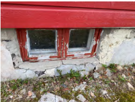
Det må påberegnes utbedring av mur.
