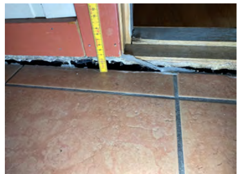
Setningsskader i gang/entré.
