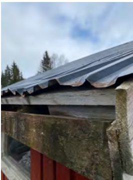
Rust/skader i nedkant av plater
