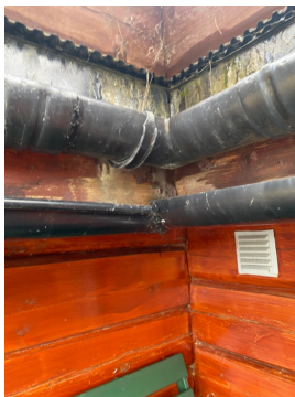
Manglende beslag/tetting med bruk av fugemasse.
