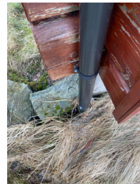
Ingen synlig drenering mot grunn.
