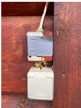
Utvendig stikkontakt, manglende deksel, synlige ledninger.
