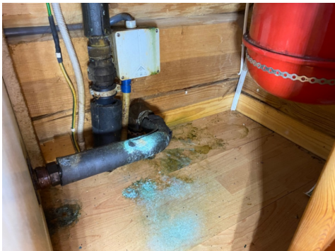
Lekkasje på rørinntak.
