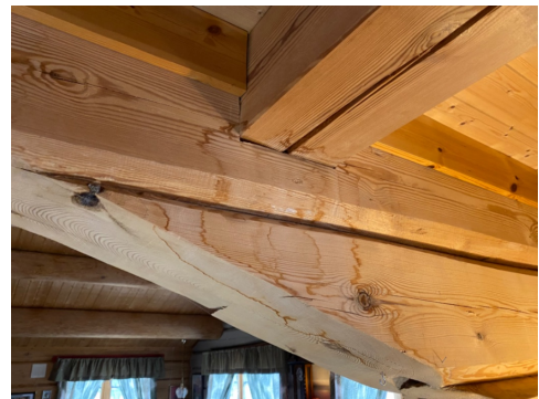
Fuktskjolder mellom gang/stue.
