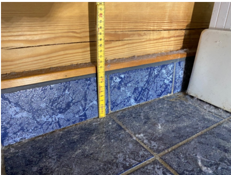
Manglende fuging mellom vegg/gulvflis.
