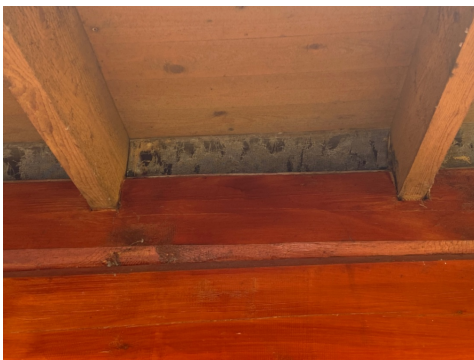
Det er registrert åpninger i netting flere steder mot raft.
