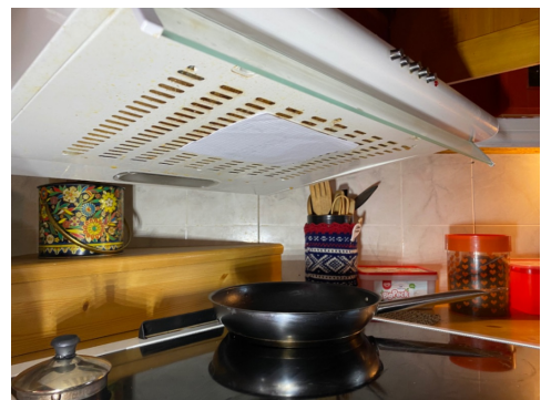
Funksjonstest av ventilator.
