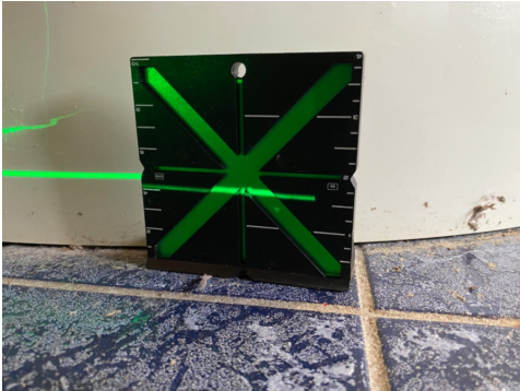
Måling av fallforhold til kabinett
