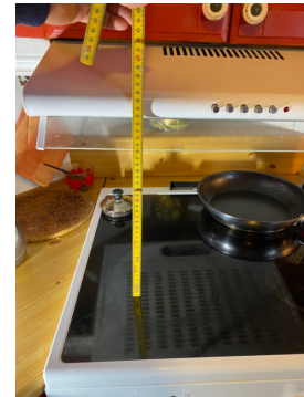
Ventilator er plassert nærme komfyr.
