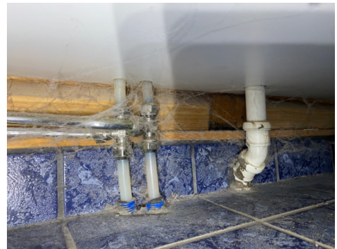
Ikke fagmessig rørgjennomføringer, ingen synlig mansjett/membran.
