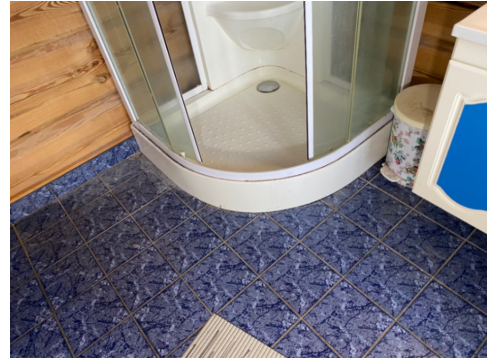
Sluk er ikke inspisert grunner fastmontert deksel på kabinett
