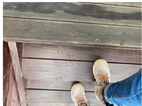
Svikt i trinn ved belastning.
