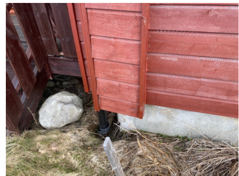
Enkelte nedløpsrør er tilkoblet rør til grunn.
