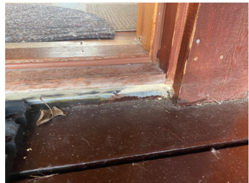
Manglende beslag i nedkant/utett pakning.
