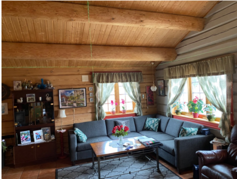
Skjevheter i takkonstruksjon.
