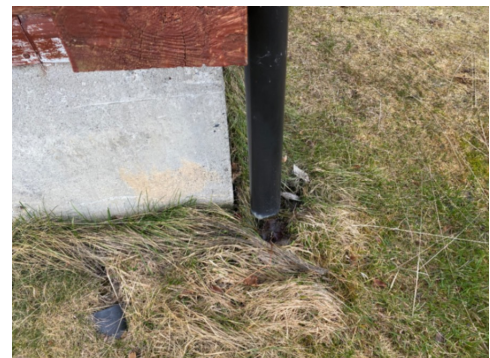
Manglende tilkobling av nedløpsrør til grunn.
