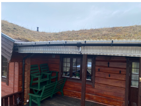
Manglende beslag mot takrenne.
