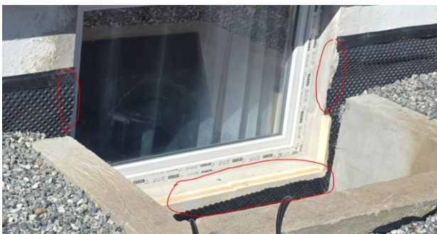
Mangler avslutning rundt vinduer.
