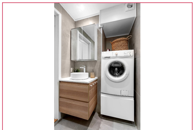
vaskesøyle på bad.
