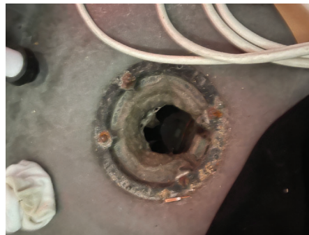
Bildet viser sluk i vaskerom.
