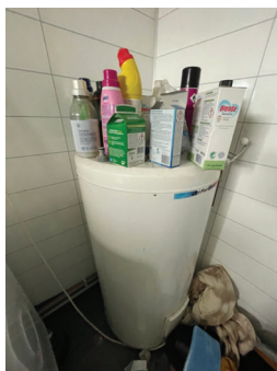
Bildet viser varmtvannsbereider.
