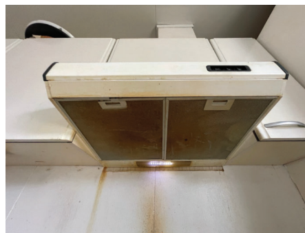
Bildet viser kjøkken ventilator.
