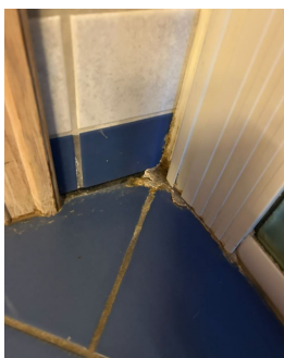
Svertesopp på fug og silikon, må renskes.
