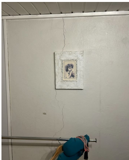
Sprekk i mur pipe ved soverom i loftsetasje.
