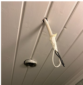
Kappe med justeringsmulighet mangler på ventilasjonsrør.
