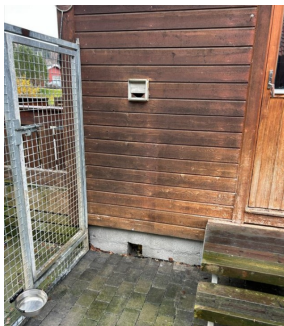
Ventil mangler på mur og spjeld mangler på veggventil.
