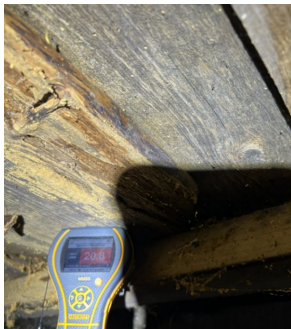
Fuktmåling i trevirket viser 20,8% metning i trevirket. Bør ligge under 16%.
