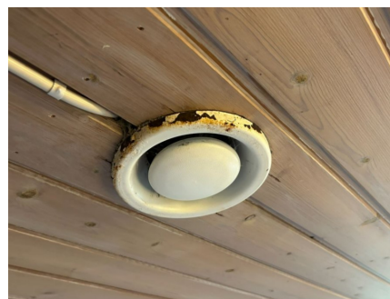
Rust på ventil i himling, må renskes og males på nytt
