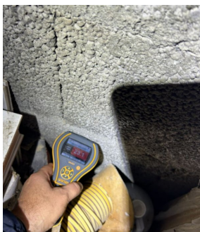
Måler fukt på 23,1%. Bør være under 16%.
