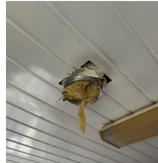
Ventilasjonsrør tettet med isolasjon
