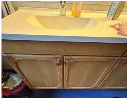
Slitasje, håndtak mangler.
