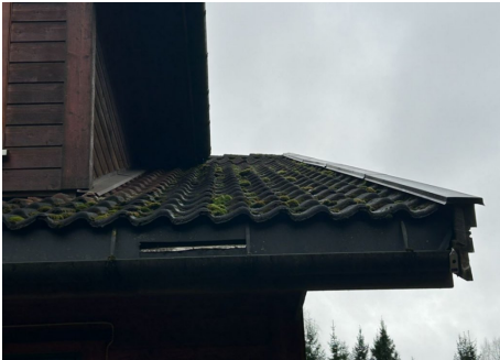
Mose på taket som må fjernes.
