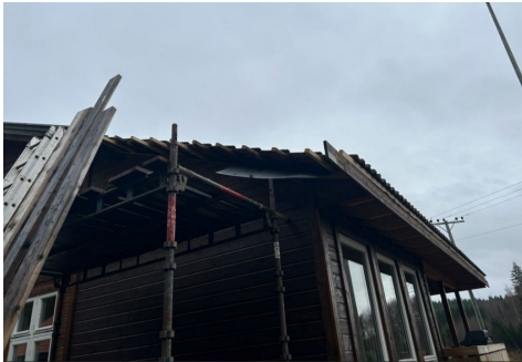
Beslag, renne og nedløp mangler.
