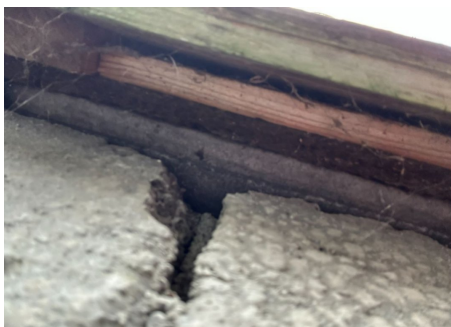
Hull i steinen opp mot svillen. Må tettes med egnet masse.
