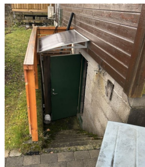
Leca må slemmes ell. Så ikke noe sluk i bunn av trappen. Ukjent om hva som er tenkt her for å fjerne regnvann i bunnen av trappen.
