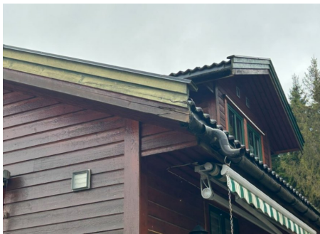
Nedløp mangler, råte på vindski.
