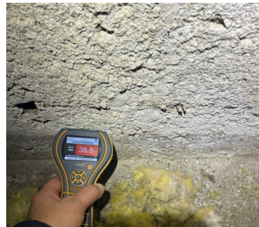
Fuktmåling av vegg i krypkjeller viser 35,5%.
