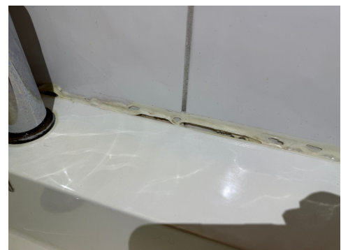
Sprukket fuge mellom servant og vegg
