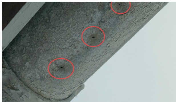
Indikasjoner på lekkasjer
