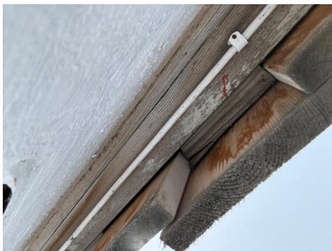
Ikke luftet kledning i nederkant
