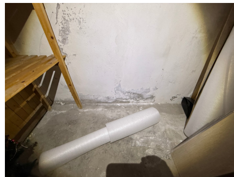
Saltutslag på innvendig grunnmur
