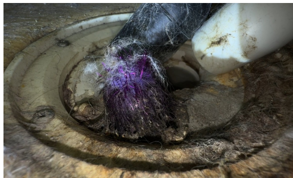
Sluk i gulv under dusjkabinettet
