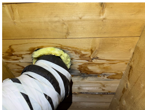
Fuktskjolder rundt ventilrørets gjennomføring i yttertaket
