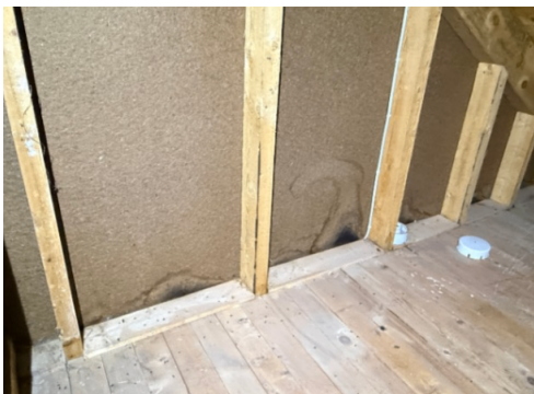
Misfarginger i røstvegger
