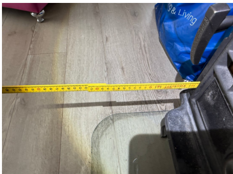
Ubrennbar plate foran vedovnen
