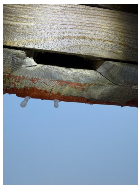
Utspring i 1. etasje mangler musesperre
