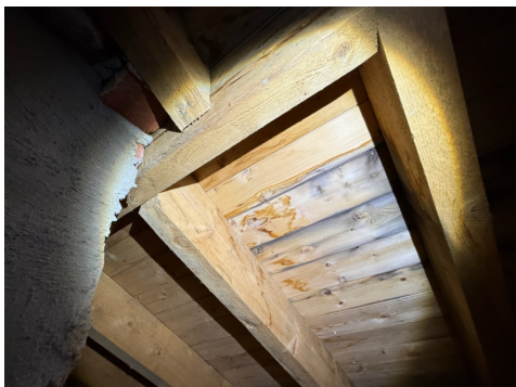
Fuktskjolder rundt pipegjennomføring
