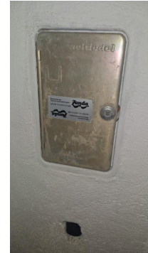
Zanda pipe fra fyrrom med keramisk røykrør.
