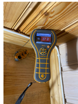
Det er målt høye fuktverdier i panelet i kjeller.
