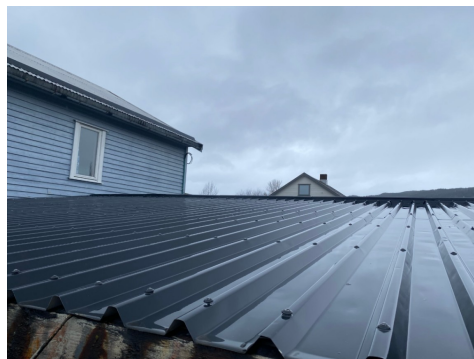
Tak over bod, manglende snøfangere.
