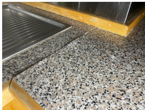
Svelling i benkeplate.
