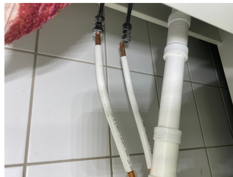
Åpne vannrør uten blanding.
