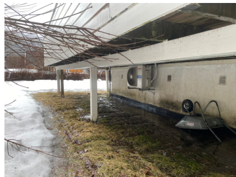
Skjevheter i konstruksjonen.
