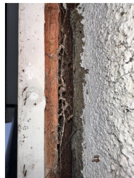
Lite til ingen lufting bak kledning.
