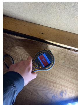
Fuktutslag på gulvbelegg i kjellerbod.
