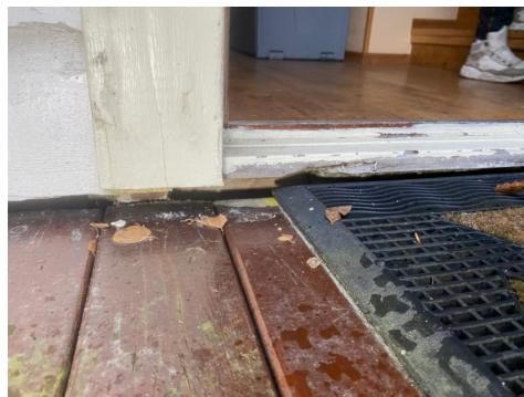
Mangler beslag og fuktskade i terskel.
