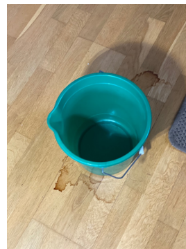
Lekkasje fra taket mellom stue/kjøkkenet.
