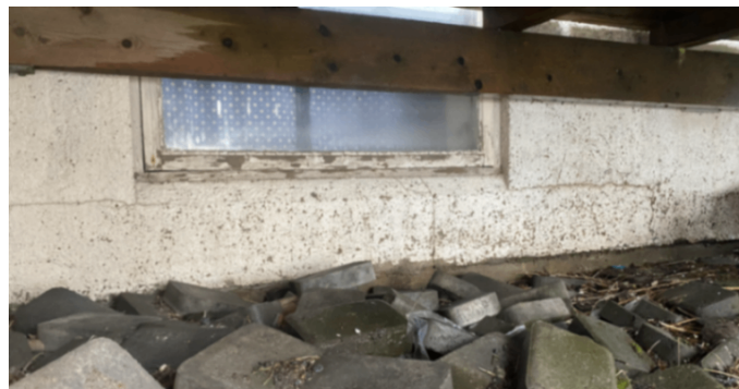
Riss i mur.
