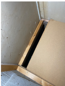
Veggplate over himling mot nabo.
