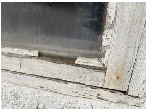
Skade i kitt på kjellervindu.
