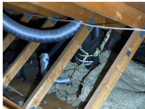
Fuktskjolder på underside av undertak.
