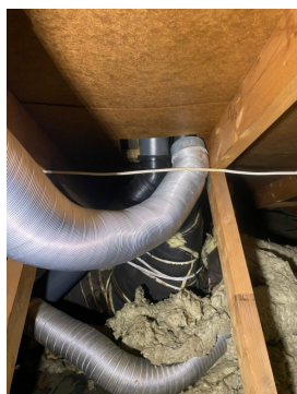
Feil ved gjennomføring i undertak. Åpen konstruksjon.
