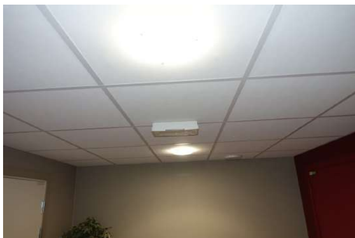
Himlingsplater på fellesareal.
