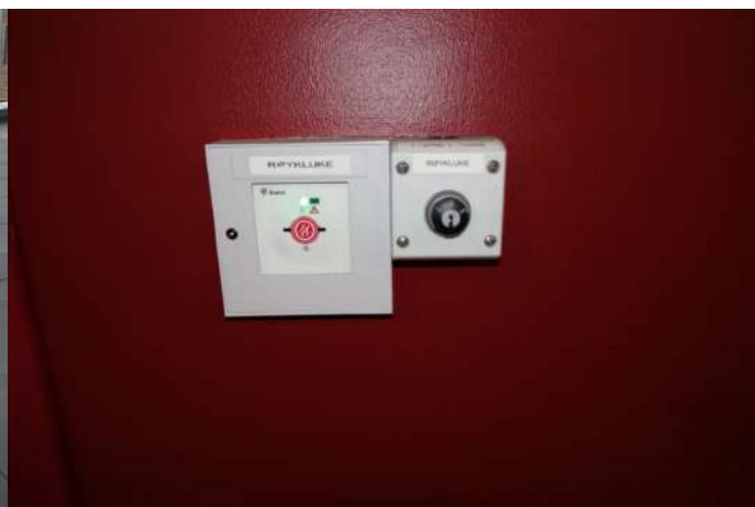
Styringspanel montert i inngangsparti.
