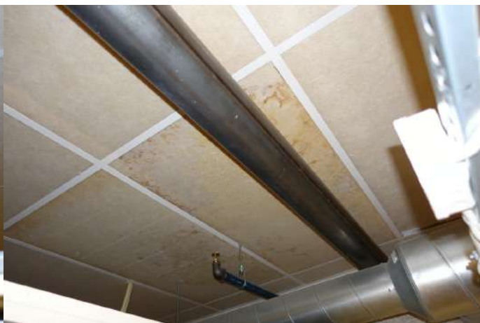
Himlingsplater med fuktskader.
