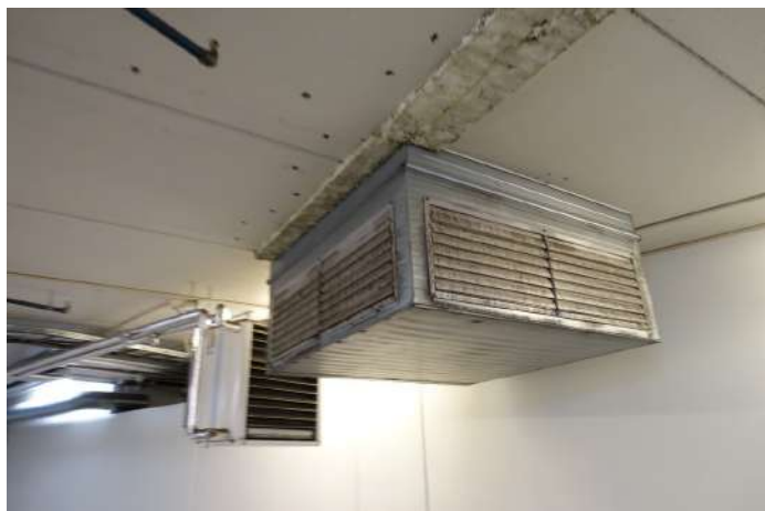
Mekanisk avtrekk for parkeringsanlegg.
