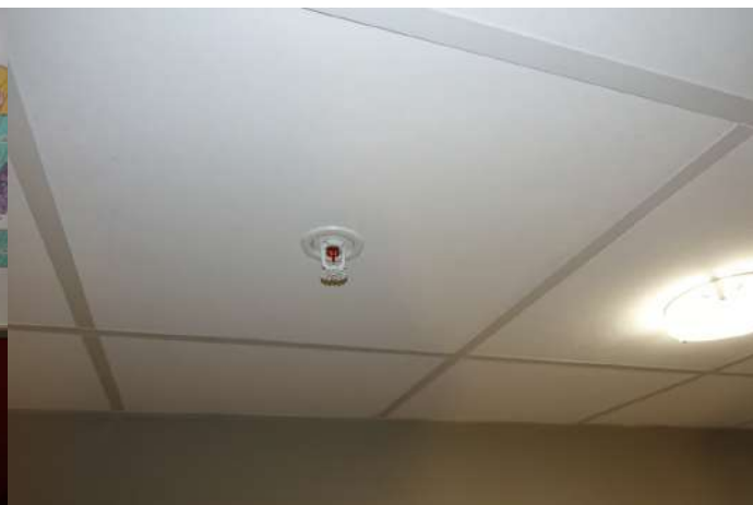
Sprinkler i fellesareal.
