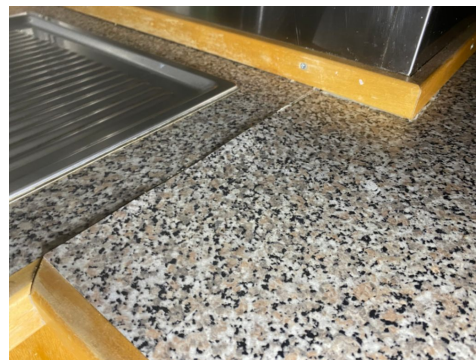
Svelling i benkeplate.
