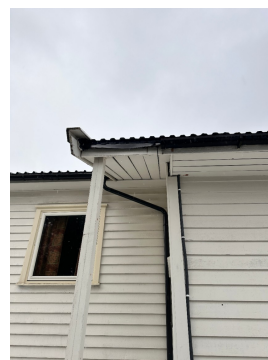
Mangler takrenne ved garasje.
