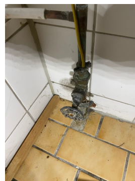
Vannlås med usikker funksjon.
