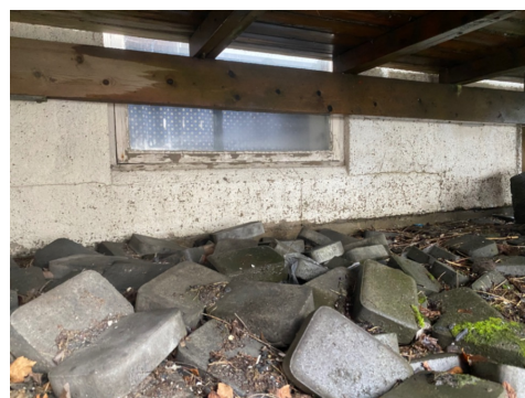
Ingen synlig fuktsikring mot mur.
