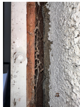
Lite til ingen lufting bak kledning.
