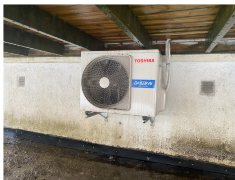
Varmepumpe utvendig del.
