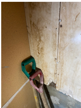
Fuktskjolder/stedvis skader i veggplate.
