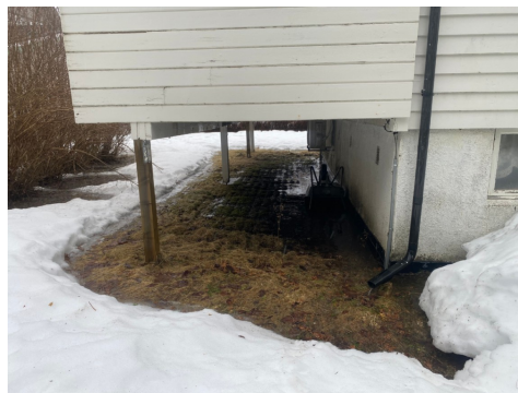
Nedløp avsluttet mot mark ved mur.
