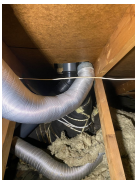
Feil ved gjennomføring i undertak. Åpen konstruksjon.
