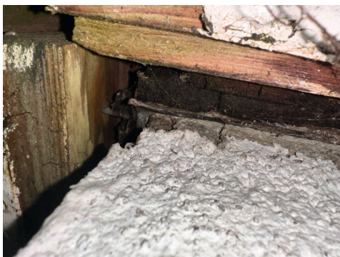
Ingen musestopper, lite lufting vbak kledning.
