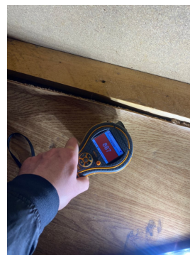
Fuktutslag på gulvbelegg i kjellerbod.
