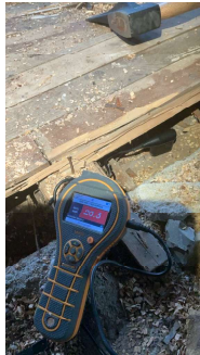
Forhøyede fuktverdier måles i tilfarergulv
