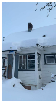
Gammel og svekket takkonstruksjon med dårlig ventilasjon
