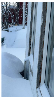
Manglende innpussing av vinduer utvendig samt innvendig foringer og rammer mangler
