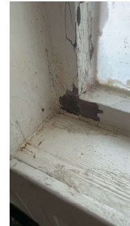
Vinduer med råteskader samt skader stedvis på rammer og karmen
