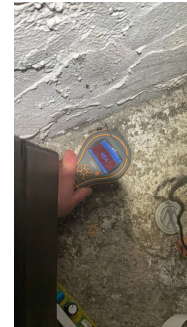
Høye fuktverdier samt saltutslag registreres stedvis
