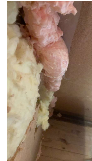
Dårlig klemt dampperre/Byggeskum er brukt stedvis noe som ikke er fulverdig løsning for klemming av dampperre
