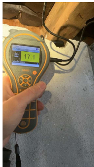
Forhøyede fuktverdier måles i sviller
