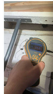
Høye fuktverdier måles i bjelker og sviller
