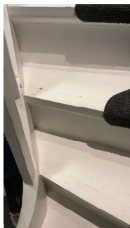
Stedvis overflateavflassing og mindre skader
