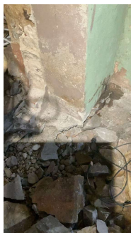
Dårlig understøttelse av pipe i kjeller
