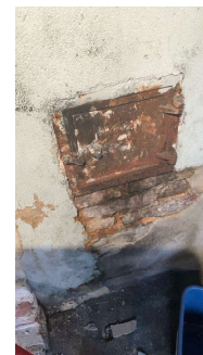
Dårlig sotluke som ikke lot seg åpne
