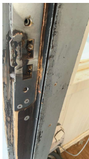
Skader på karmen og rammer samt overflater på hoveddør
