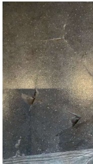
Skader på fliser rundt ovn samt høy slitasje på ovn
