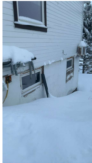
Manglende utvendig ferdigstillelse
