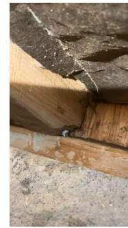
Mindre råteskader samt manglende isolasjon stedvis
