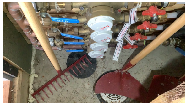
Felles bod utenfor enheten med hovedstoppekran og vannmåler.
