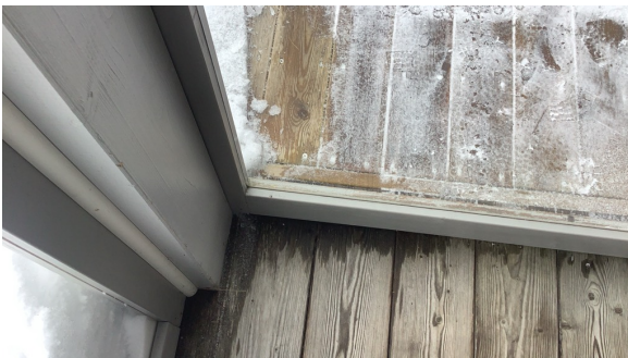
Enkle dører/ levgger. Kan ikke forventes at de er tette. Det er laget for le for vinden.
