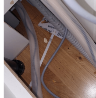
Det er lagt vannføler under oppvaskmaskin.
