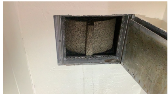
Det er sotluke-stein i feieluken.
