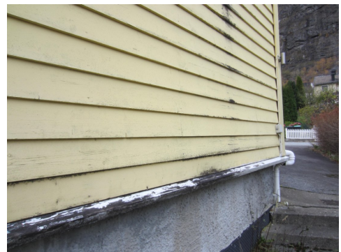
Fasade med slitasje og trong for vedlikehald.
