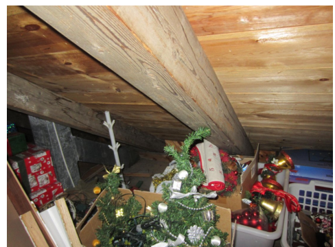
Uisolert på kott
