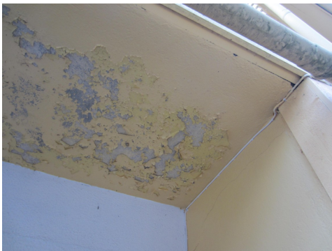
Måling under dekke flassar.
