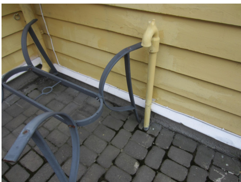
Typisk lufterøyr for oljetank
