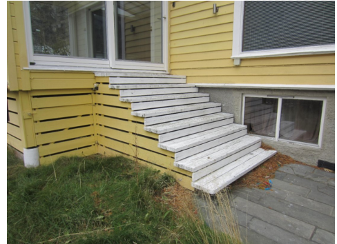
Det er ikkje montert rekkverk på trapp.
