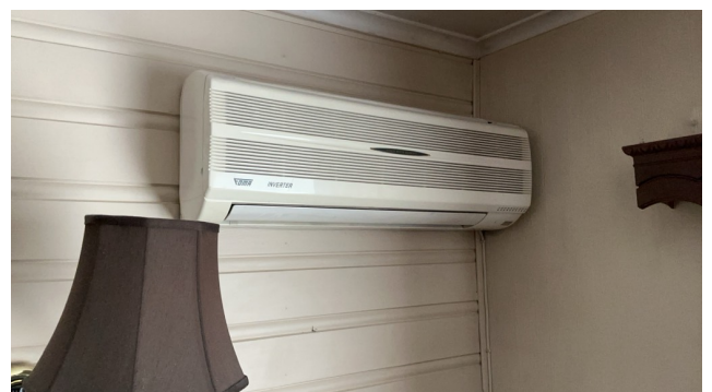
Varmepumpe som ikkje var i drift, ukjent om den er i funksjon.
