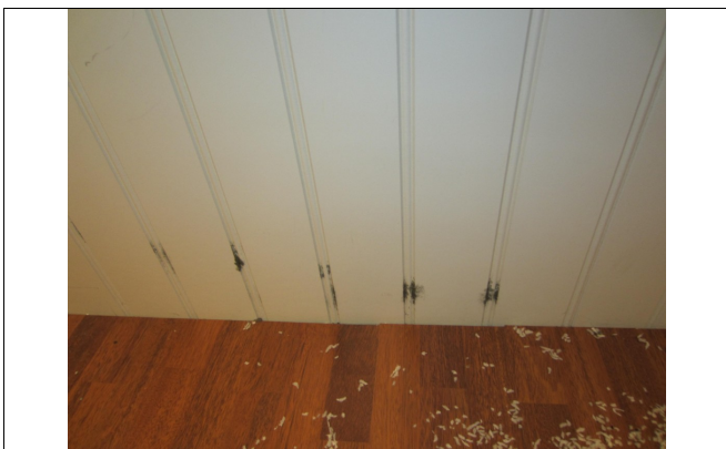
Missfarging på vegg i kjellar
