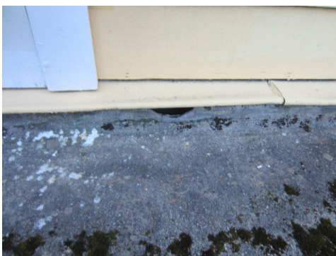
Usikker overgang dekke-vegg på altan.
