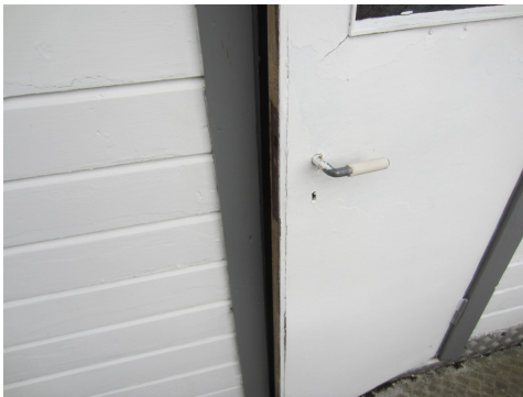
Balkongdør, eldre innerdør som ikkje tettar tilfredstillande.
