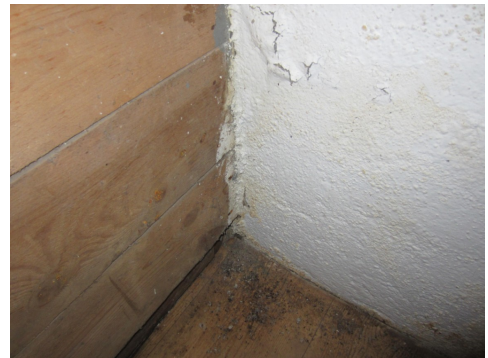
Treverk som er i direkte kontakt med fuktig mur
