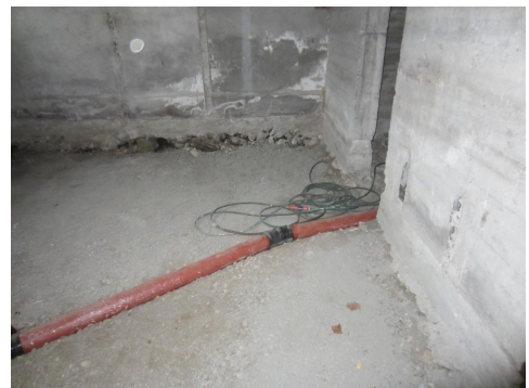
Del av kjellar der golv er fjerna.
