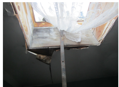
Fuktskade ved takvindauge.
