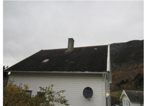
Døme på skada eternitt heller
