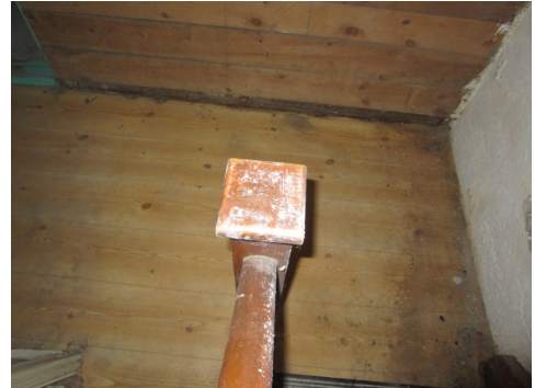
Begroing som tyder på høgt fuktinnhald.
