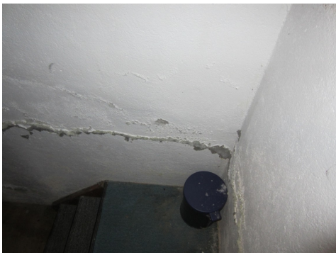
Sprekker og fuktinntrenging
