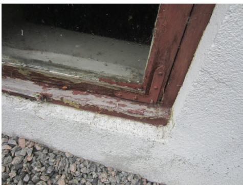
Døme på kjellarvindauge som er skada.
