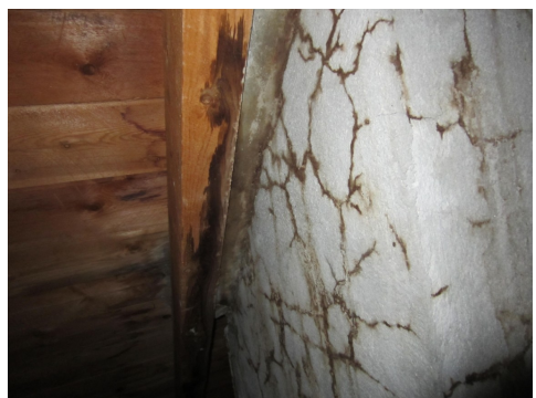
Fuktrender ved pipe.
