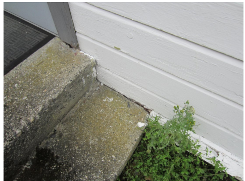
Vegg er utsett for fukt der trapp ligg inntil veggjen
