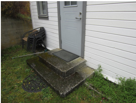
Hoveddør, det er liten klaring til betontrapp
