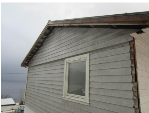
Vegg som er uferdig, svertesopp på overflate
