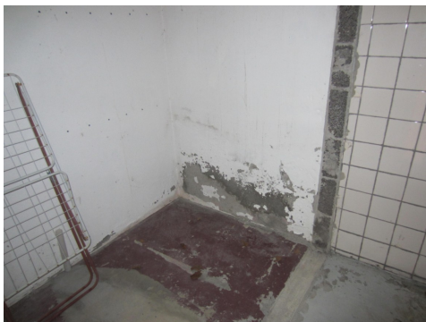
Måling flassar, kan tyda på fukttransport
