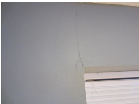
Sprekk i overflate på vegg
