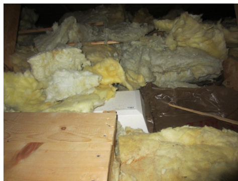
Rusken isolering, utett mellom spotkasse og dampsperre.
