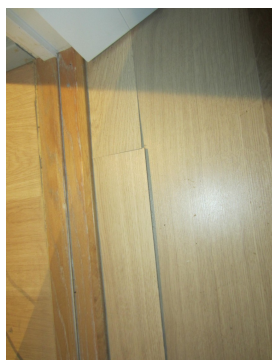
Laminatgolv som ikkje er montert rett
