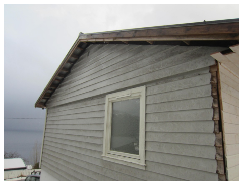
Gavlbeslag er ikke ferdig montert
