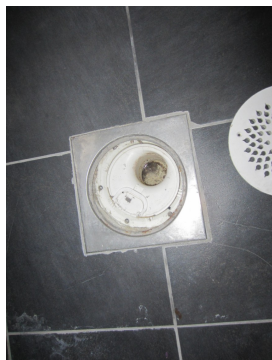
Ikkje synleg membran ved sluk
