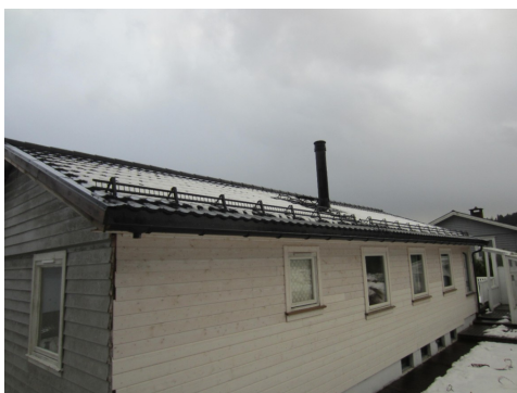
Vegg som ikkje er ferdig måla.
