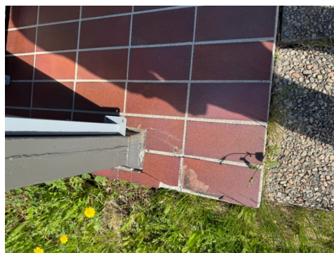
Det er registrert skade på flisebelagt terrasse.
