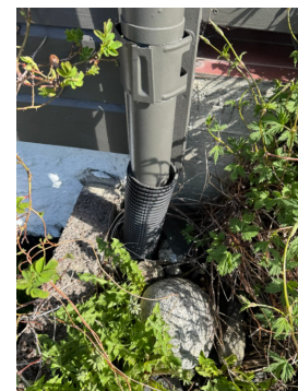
Takrennene er tilkoblet rørsystem for bortledning av vann.
