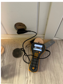
Bildet viser fuktmåling i bunnsvill mellom bad og vaskerom.
