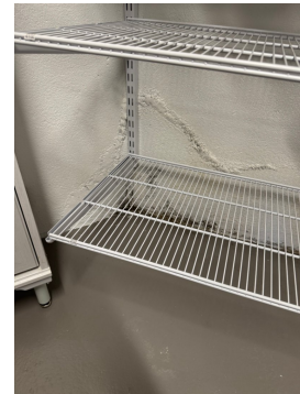
Saltutslag registrert. Saltutslag er en sikker indikator på fuktgjennomgang.
