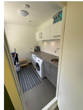
Oversiktsbilde vaskerom. Vaskerommet er funksjonelt og i daglig bruk, men det tilfredsstillende ikke dagens krav til våtrom.
