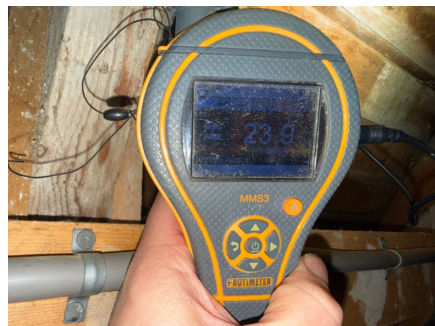
Høye fuktverdier på kaldloft
