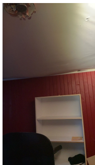
Store skader på innvendig overflater
