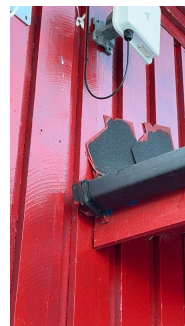
Manglende tetthet i overgang mellom garasjetak boligen. Feilmontering av beslag.
