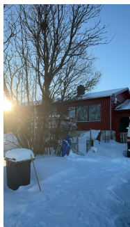
Snødekt tak som er begrenset undersøkt på grunn av snø forhold.
