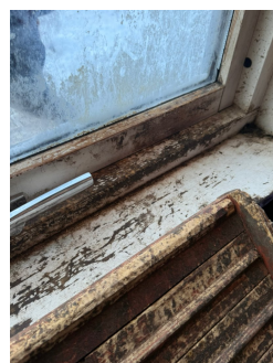
Store skader på vinduer innvendig
