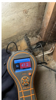
Høye fuktverdier måles i trevirke mot yttervegg
