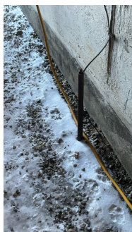
Utvendig stoppekran virker og være i dårlig forfatning
