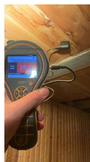
Høye fuktverdier måles i bjelkelag
