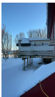
Veranda med rekkverk som er for lavt samt skjevheter og manglende vedlikehold over år
