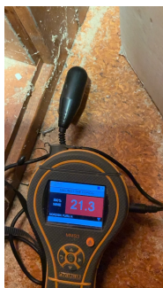
Høye fuktverdier måles i oppforet tregulv
