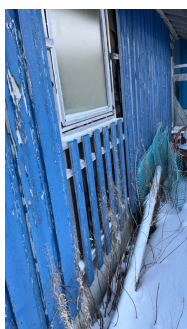
Manglende ferdigstillelse, råte og fuktskader må påregnes
